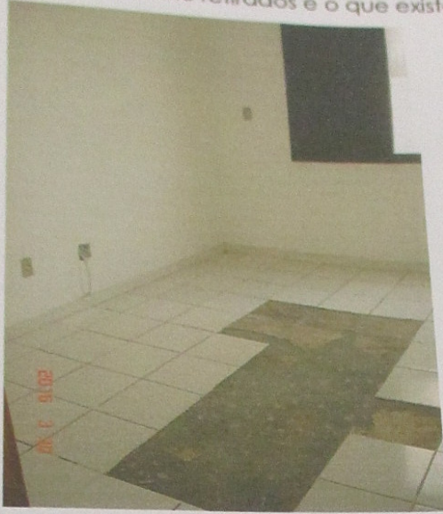
Foto 08 – Pisos de um do dormitório retirados e o que existem estão soltos.
