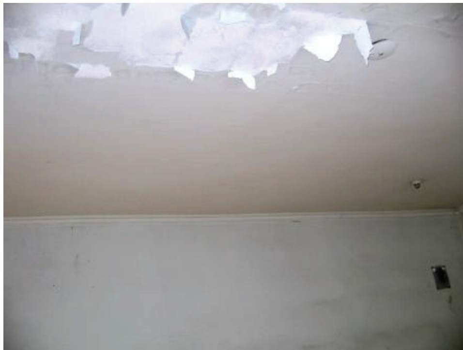
Foto 5 – Edificação da frente, sala da direita, da frente: decomposição no revestimento do teto.
