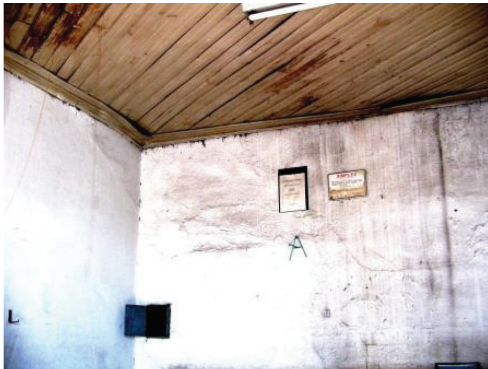
Foto 3 – Edificação da frente: interior do ambiente denominado “garagem” na planta do ANEXO II
