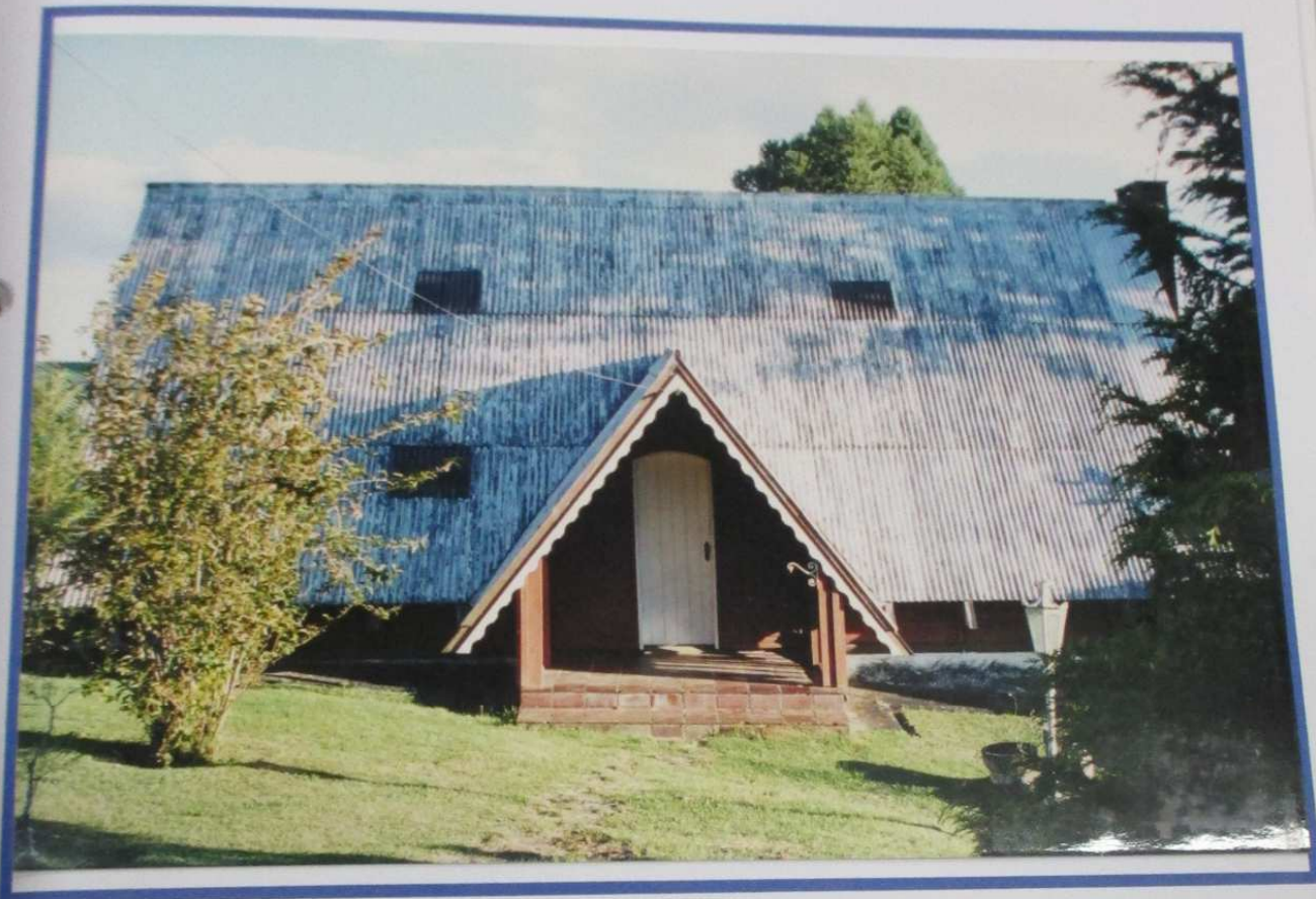
Foto 2 – Vista da entrada da construção existente sobre o lote 24, observando-se que a mesma encontra-se desocupada.
