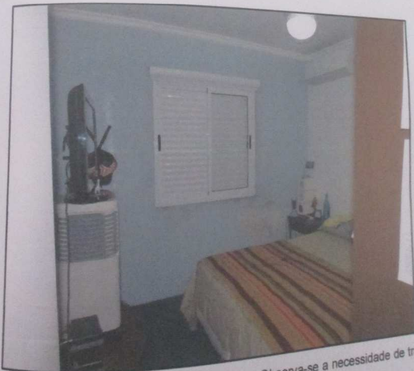
FOTO 20 – Vista parcial da Suite. Observa-se parede decorada com papel de parede e a necessidade de tratamento de infiltrações pelo caixilho..
