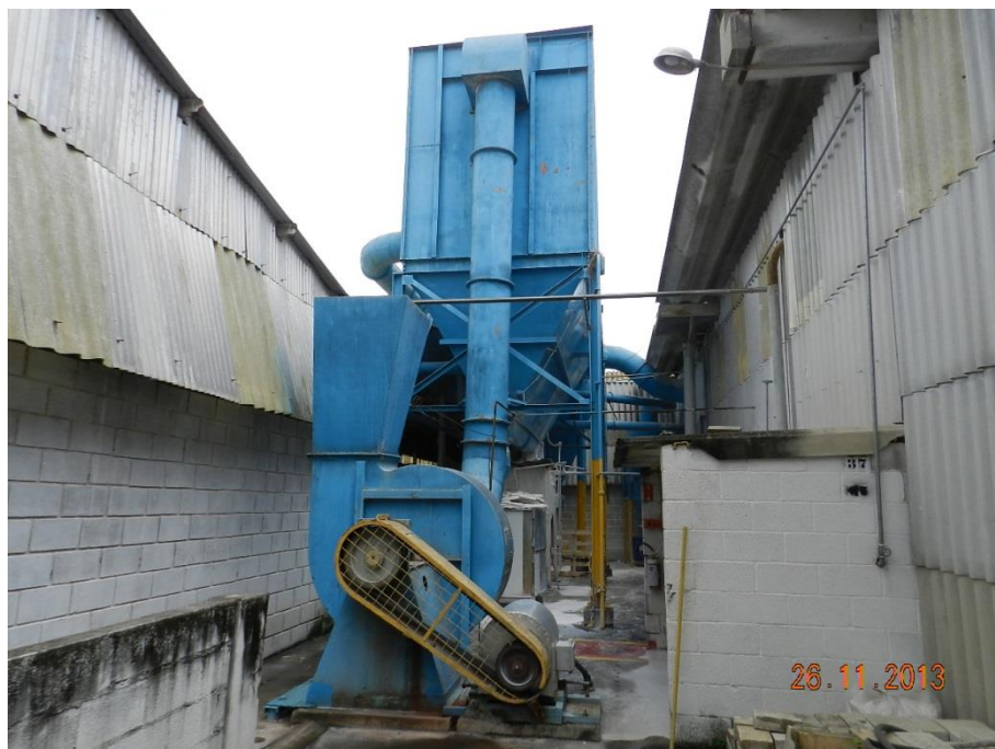
Vista do sistema de filtragem do ar da fábrica.
