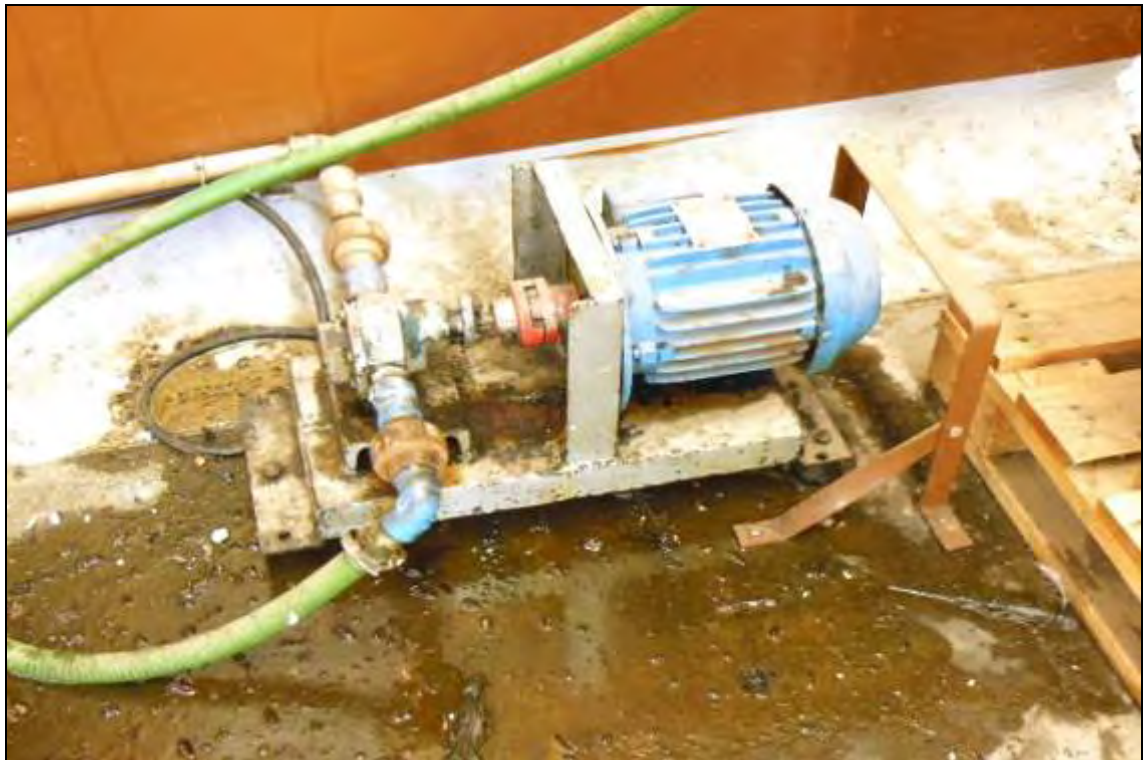
ITEM 1,037 – VISTA DA BOMBA CENTRIFUGA PARA ALIMENTAÇÃO DO TANQUE DE LECETINA DE SOJA COM MOTOR ELÉTRICO 0,5W
