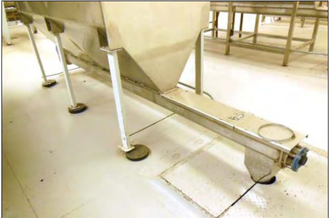
ITEM 1,032 – VISTA DO SILO FABRIMA I EM ALUMINIO COM ROSCA TRANSPORTADORA NA SAÍDA ACIONADO POR MOTOR REDUTOR
