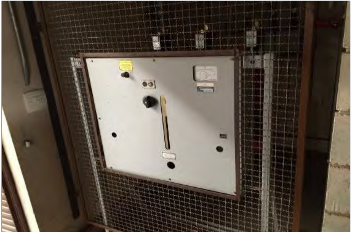
ITEM 2,213 – VISTA DO DISJUNTOR MARCA: AREVA TIPO: 356/17 SÉRIE: 5.1476/3/1
