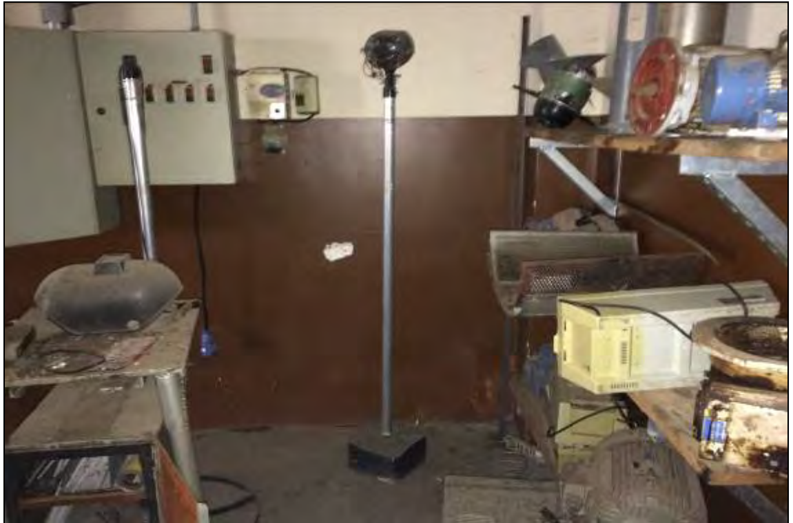
ITEM 2,345 – VISTA DO VENTILADOR DE COLUNA MARCA: VENTISILVA (QUEBRADO)
