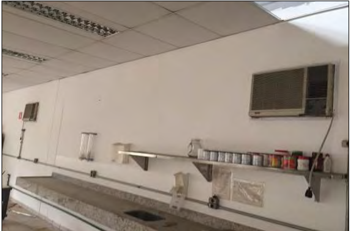
ITEM 2,277 / 2,278 – VISTA DOS DOIS AR CONDICIONADOS DE PAREDE MARCA: TOTALINE
