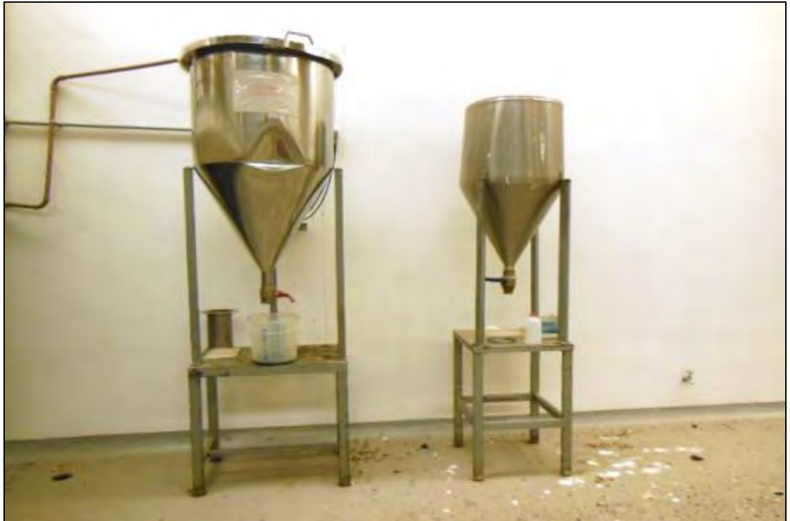
ITEM 1,035 / ITEM 1,036– VISTA DO SILO EM AÇO INOX PARA LECETINA DE SOJA MONTADO SOBRE ESTRUTURA METÁLICA E DO SILO EM AÇO INOX PARA LECETINA DE SOJA MONTADO SOBRE ESTRUTURA METÁLICA
