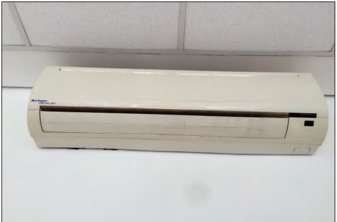
ITEM 2,202 – VISTA DO AR CONDICIONADO SPLIT MARCA: MAX FLEX
