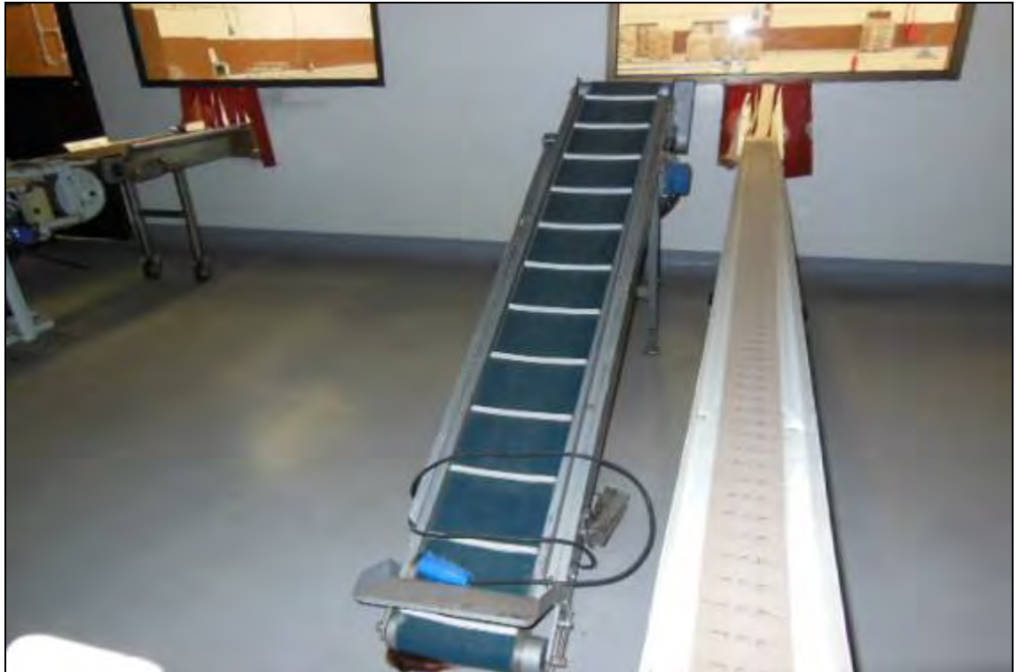
ITEM 1,046 – VISTA DA ESTEIRA TRANSPORTADORA
