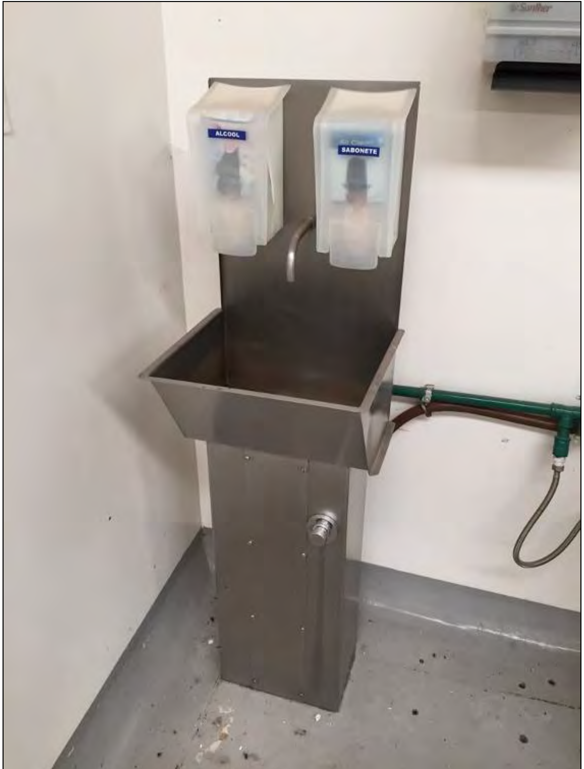
ITEM 2,384 – VISTA DO LAVADOR DE MAO ACIONADO POR JOELHO
