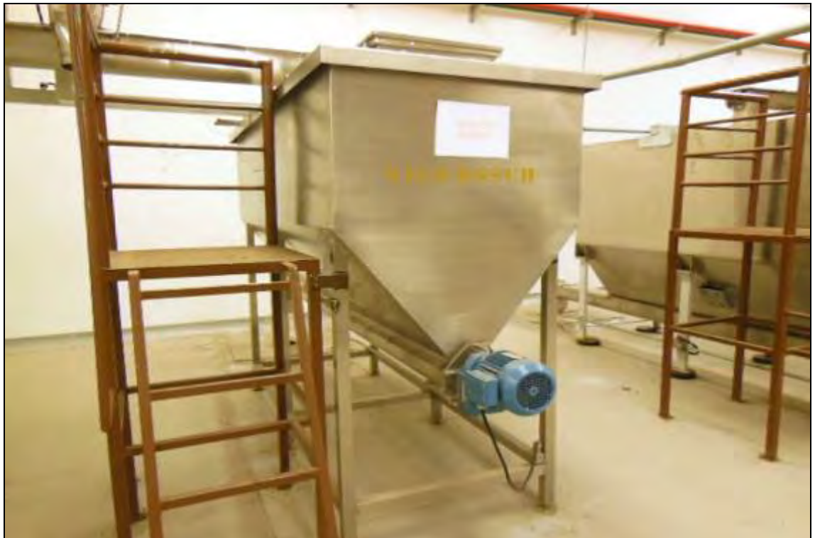
ITEM 1,027 – VISTA DO SILO BOSCH EM ALUMINIO COM VIBRADOR MARCA: DONAR E ROSCA TRANSPORTADORA NA SAÍDA, ACIONAMENTO POR MOTOR REDUTOR MARCA: SEW-EURODRIVE
