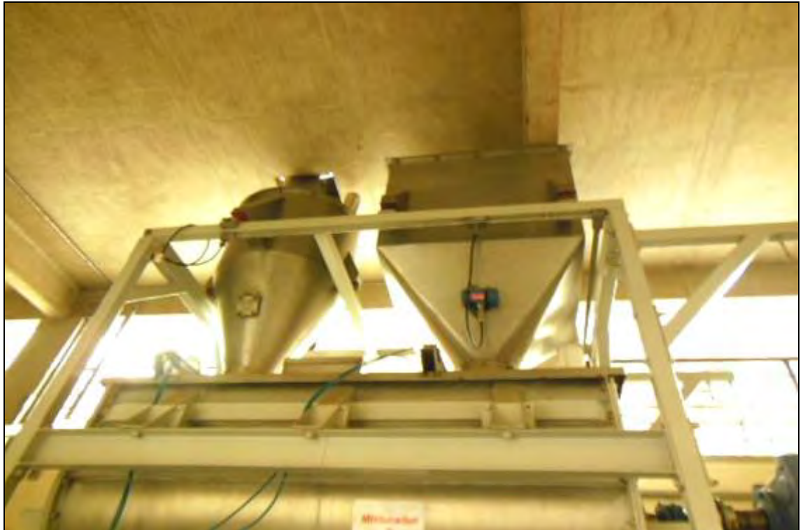
ITEM 1,011 / ITEM 1,012- VISTA DO SILO II PARA ARMAZANAMENTO DE ACUCAR EM AÇO INOX E DO SILO II PARA ARMAZANAMENTO DE CACAU EM AÇO INOX
