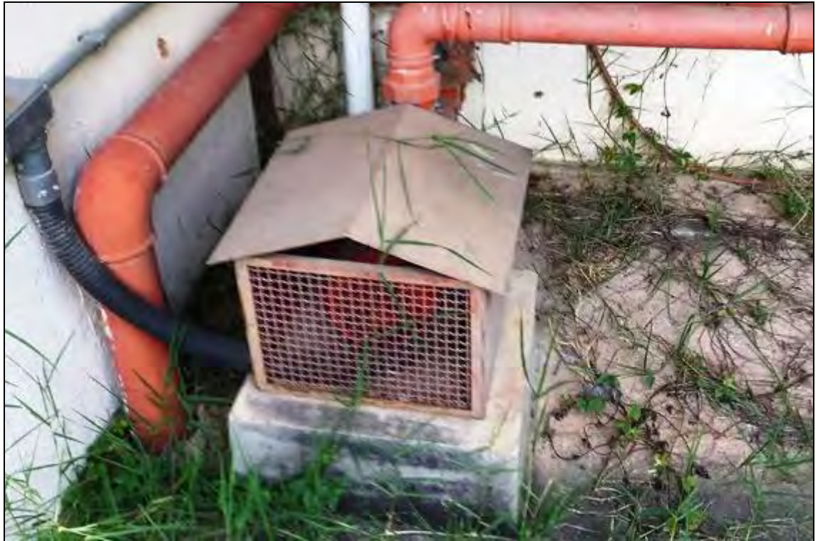
ITEM 1,095 – VISTA DA BOMBA CENTRIFUGA
