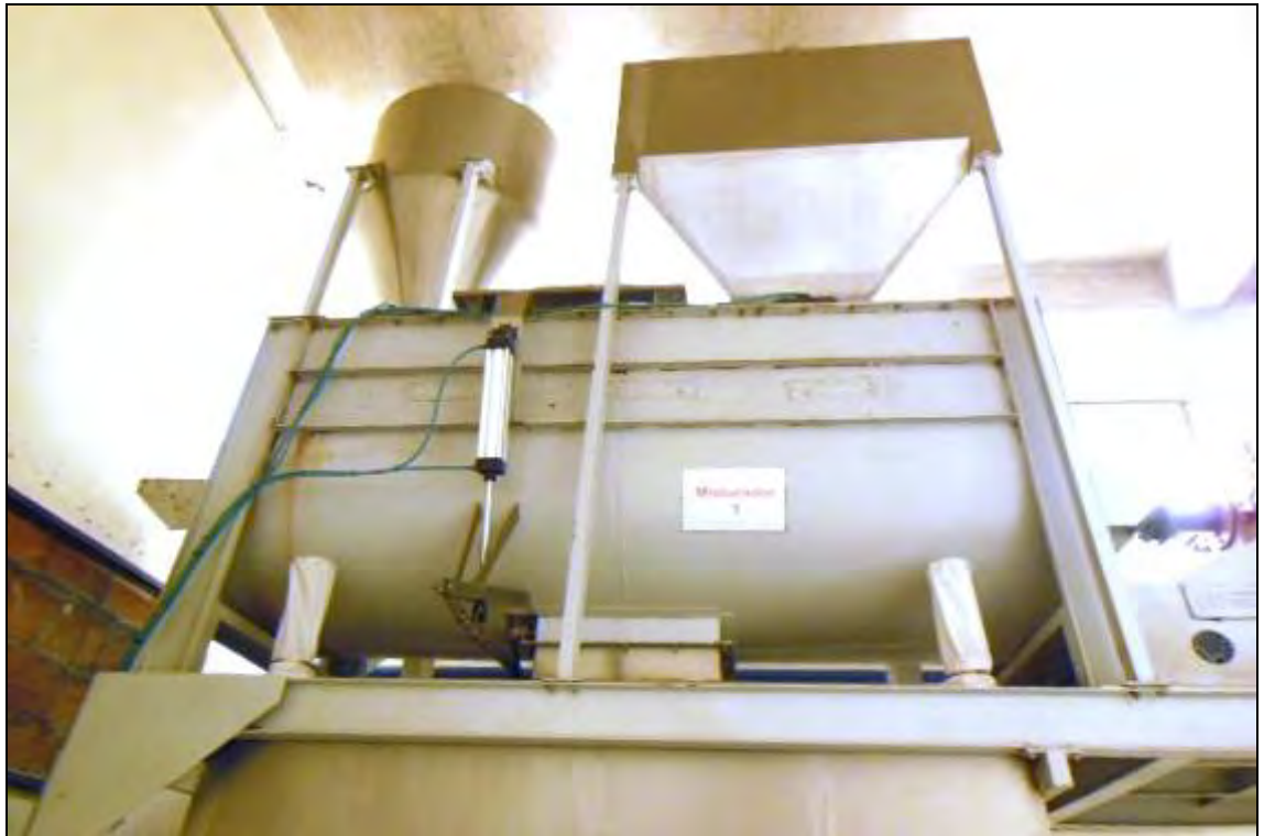
ITEM 1,005 – VISTA DO MISTURADOR I ACIONADO POR MOTO REDUTOR MARCA: FEISA
