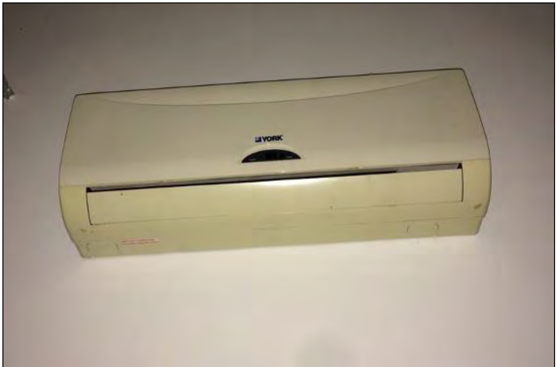
ITEM 2,132 – VISTA DO AR CONDICIONADO SPLIT MARCA: YORK
