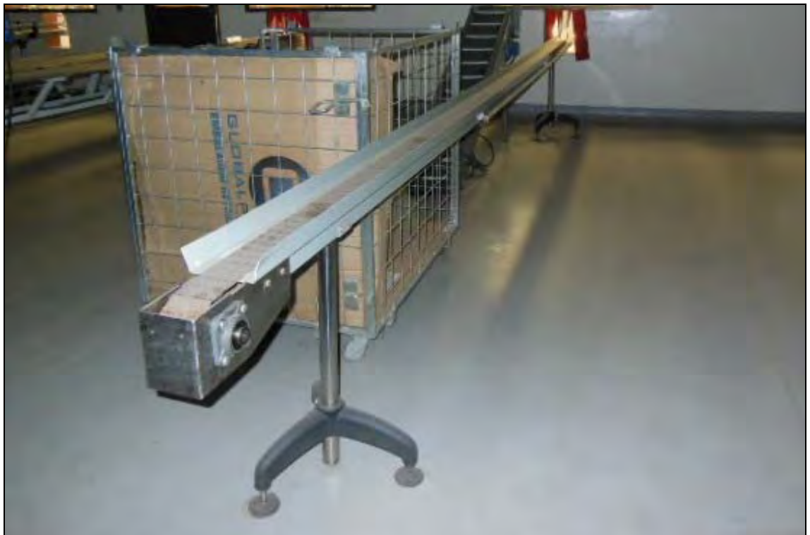
ITEM 1,045 – VISTA DA ESTEIRA TRANSPORTADORA
