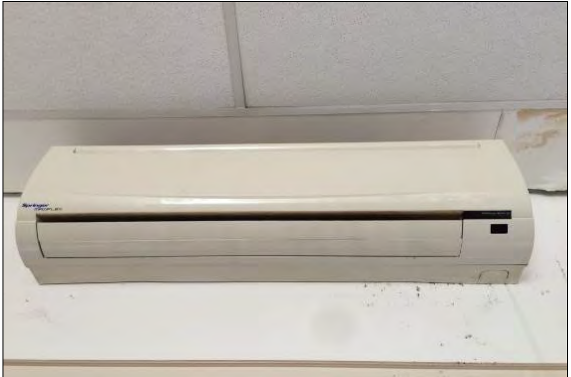
ITEM 2,203 – VISTA DO AR CONDICIONADO SPLIT MARCA: MAX FLEX
