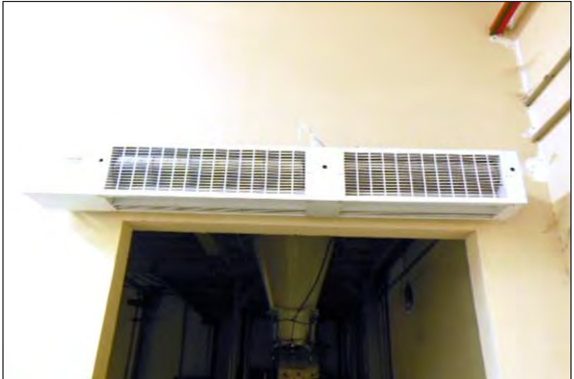
ITEM 2,251 – VISTA DA CORTINA DE AR MARCA: CSV
