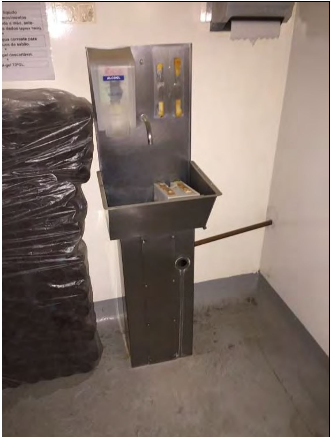
ITEM 2,385 – VISTA DO LAVADOR DE MÃO ACIONADO POR JOELHO
