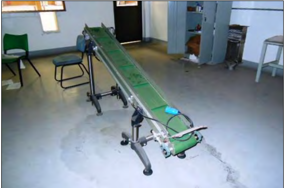
ITEM 1,050 – VISTA DA ESTEIRA INCLINADA MARCA: ARV
