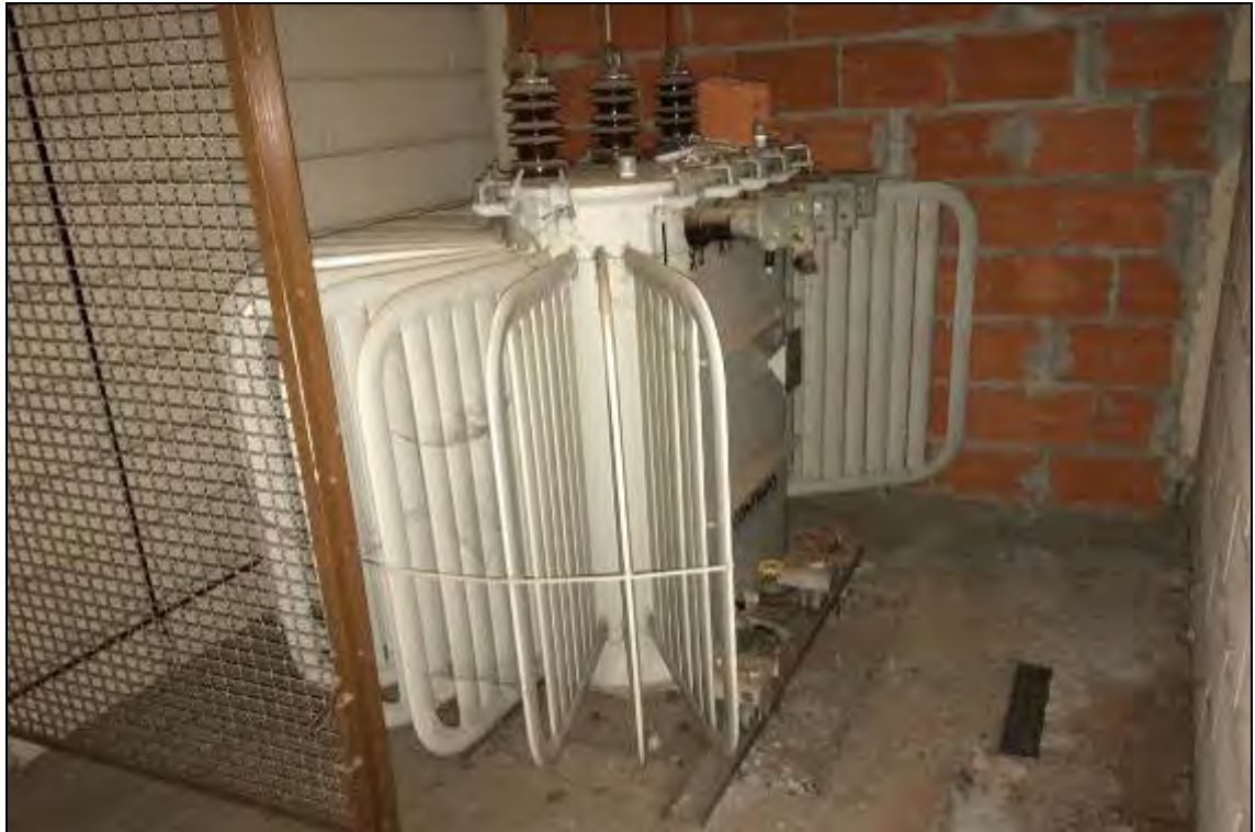
ITEM 2,212 – VISTA DO TRANSFORMADOR MARCA: COMTRAFO SÉRIE: 63407
