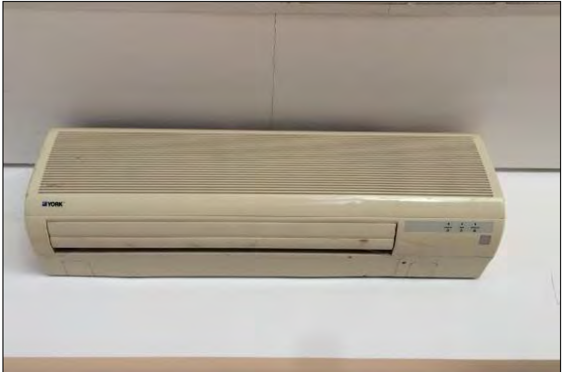
ITEM 2,187 – VISTA DO AR CONDICIONADO SPLIT MARCA: YORK
