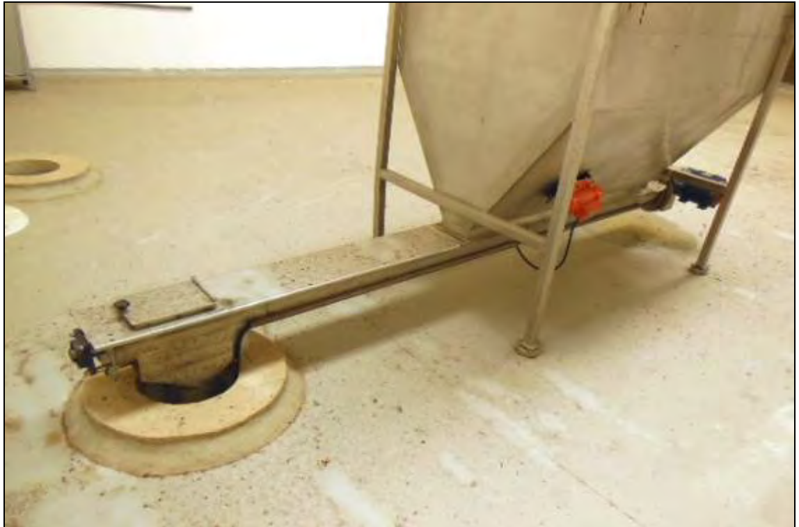
ITEM 1,034 – VISTA DO SILO FABRIMA III EM ALUMINIO COM VIBRADOR E ROSCA NA SAÍDA
