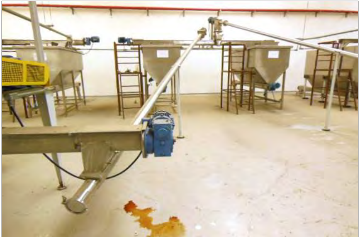
ITEM 1,025 – VISTA DO ROSCA TRANSPORTADORA Nº8 EM ALUMINIO COM MOTO REDUTOR PARA ALIMENTAÇÃO DOS SILOS MASIPACK E BOSCH
