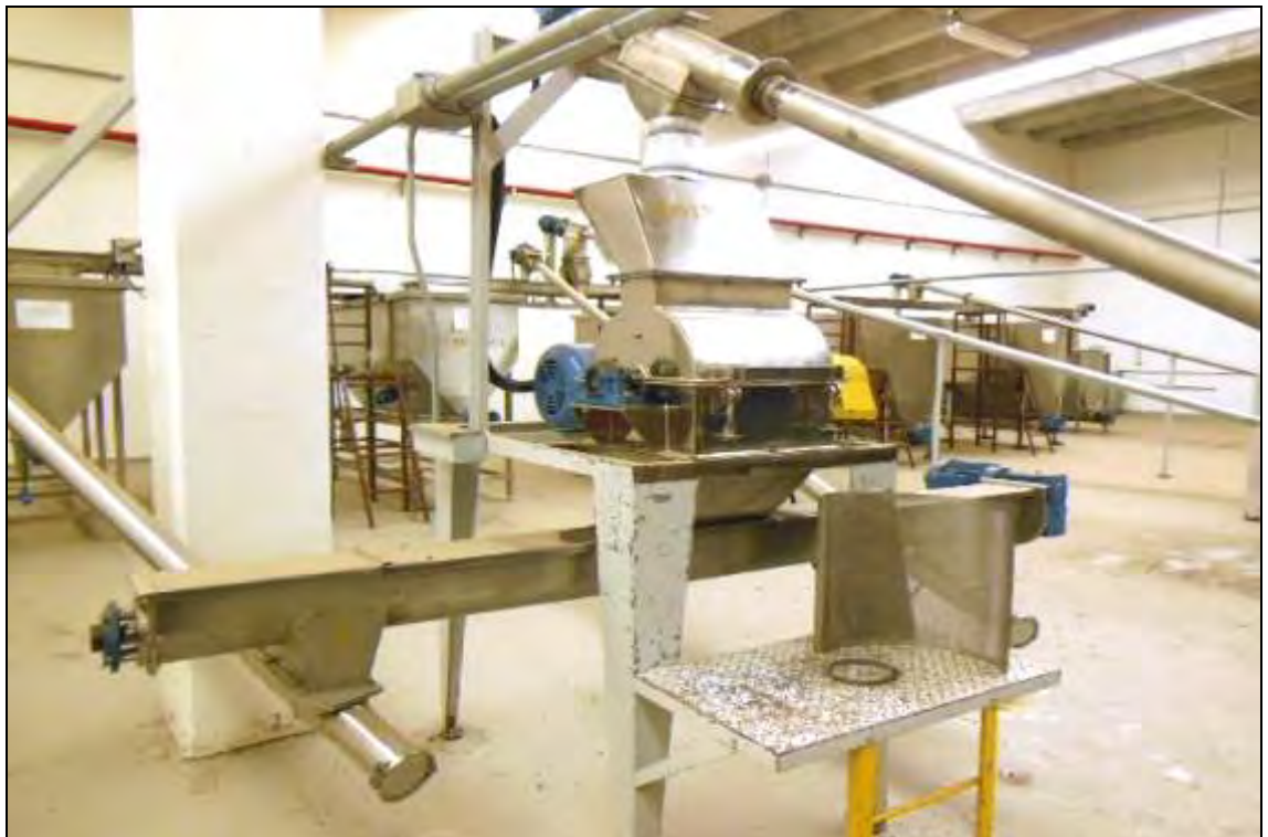
ITEM 1,017 /ITEM 1,018 – VISTA DO MOINHO I COM MOTOR ELÉTRICO 30 CV E DA ROSCA TRANSPORTADORA EM ALUMINIO NA SAÍDA DO MOINHO COM MOTOR ELÉTRICO POTENCIA: 5CV E REDUTOR COM 2 SAÍDAS
