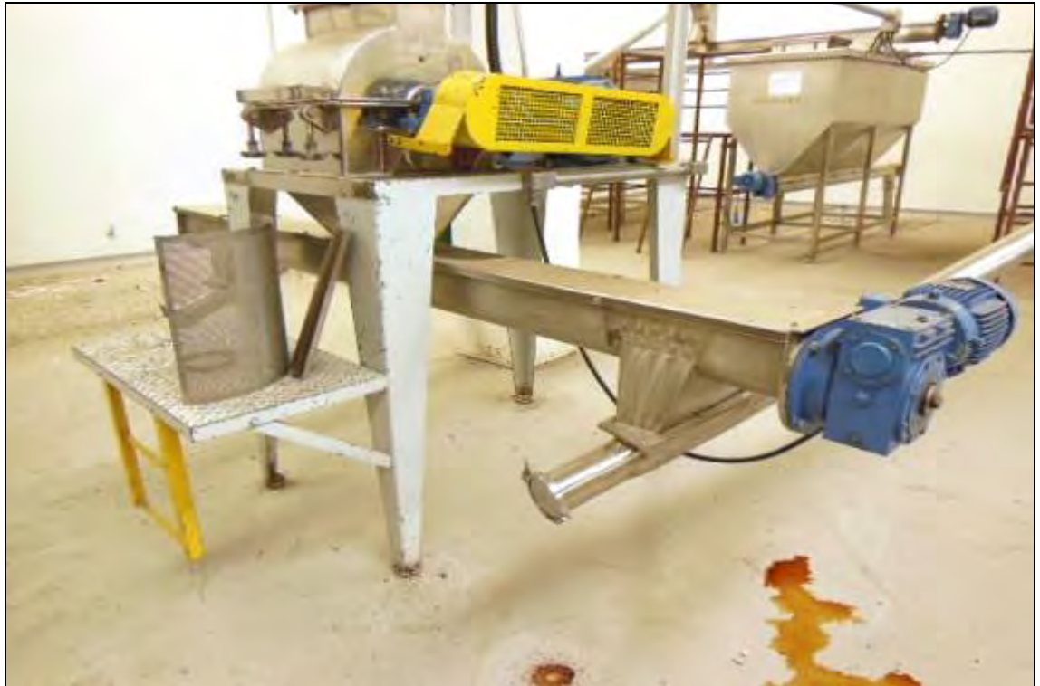
ITEM 1,022 – VISTA DA ROSCA TRANSPORTADORA EM ALUMINIO Nº 7 COM ACIONAMENTO POR MOTOR ELÉTRICO E REDUTOR PARA ALIMENTAÇÃO DOS SILOS DA ARV Nº1 E ARV Nº 2
