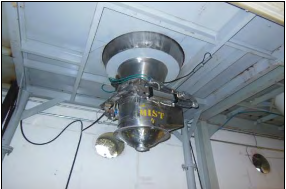
ITEM 1,066 – VISTA DO MISTURADOR IV MARCA: SEMCO FA-35 MODELO: CONIMIX CAP: 990LTS EM MEZANINO EM ACO CARBONO E ESCADA
