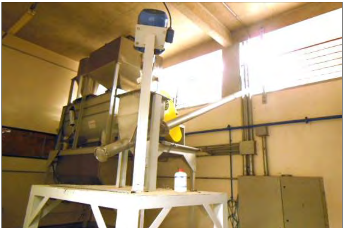
ITEM 1,008 – VISTA DA ROSCA TRANSPORTADORA EM ALUMINIO INCLINADA PARA ALIMENTAÇÃO DO MOINHO
