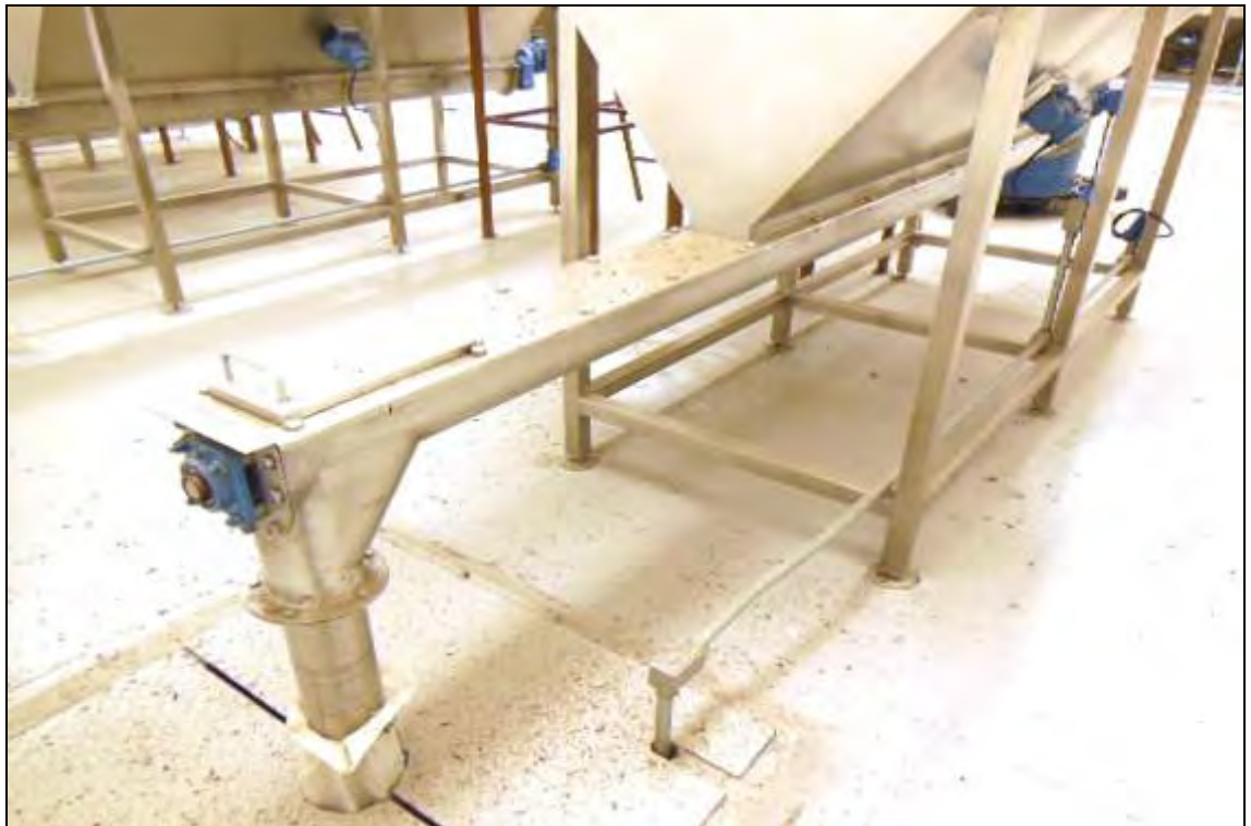
ITEM 1,023 – VISTA DO SILO ARV Nº1 EM ALUMINIO COM VIBRADOR MARCA: DONAR E ROSCA TRANSPORTADORA NA SAÍDA, ACIONAMENTO POR MOTOR REDUTOR MARCA: SEW-EURODRIVE
