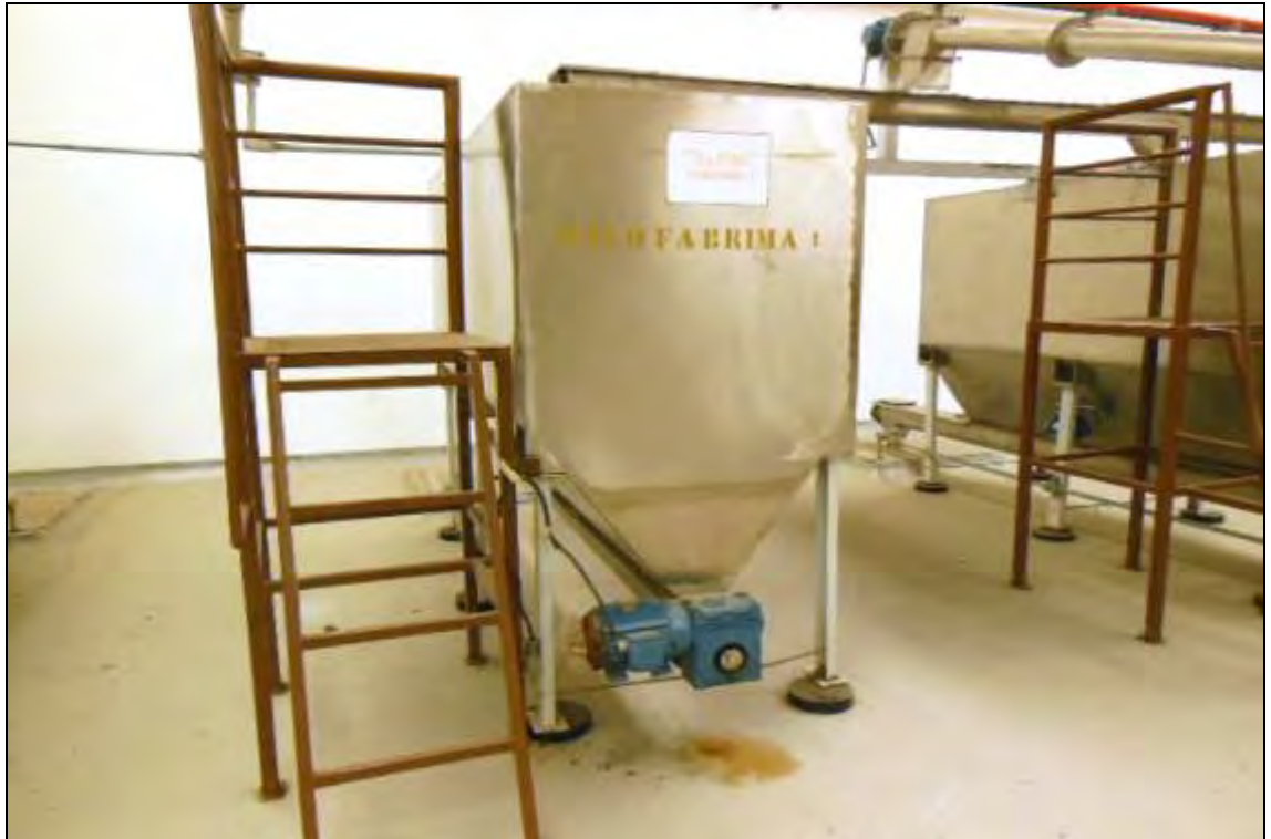
ITEM 1,032 – VISTA DO SILO FABRIMA I EM ALUMINIO COM ROSCA TRANSPORTADORA NA SAÍDA ACIONADO POR MOTOR REDUTOR
