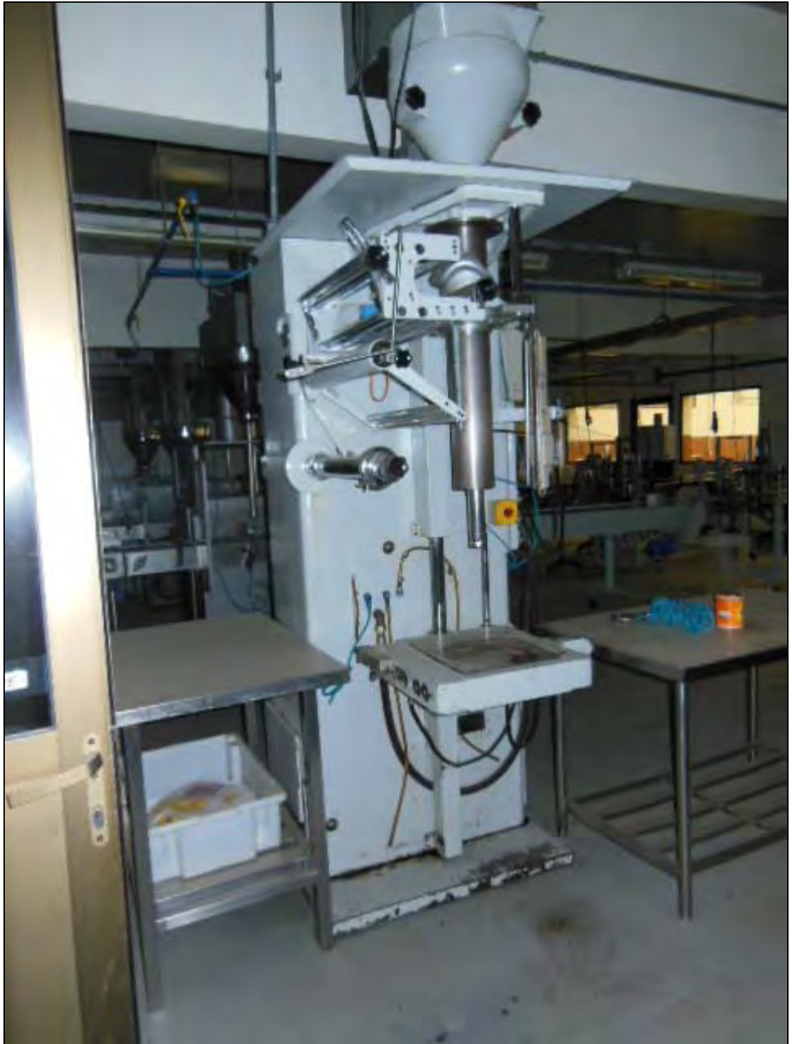
ITEM 1,042 – VISTA DA EMPACOTADEIRA MARCA: BOSH I COMPOSTA POR CORREIA TRANSPORTADORA COM RODIZÍOS COMPRIMENTO 5 M, ACIONAMENTO POR MOTOR REDUTOR E ESTEIRA DE SAÍDA
