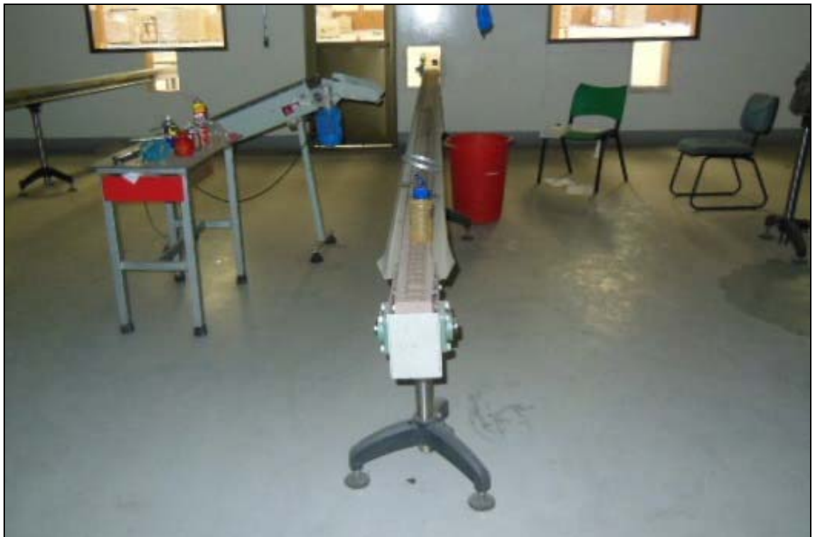
ITEM 1,049 – VISTA DA ESTEIRA INCLINADA MARCA: ARV
