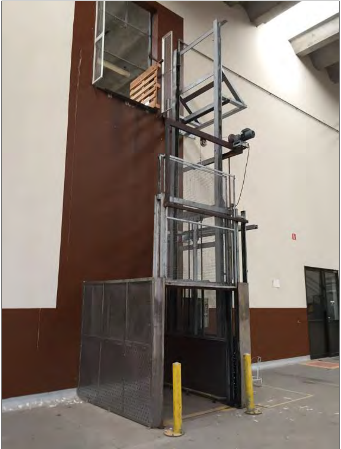
ITEM 1,091 – VISTA DO ELEVADOR DE PLATAFORMA COM CABINE
