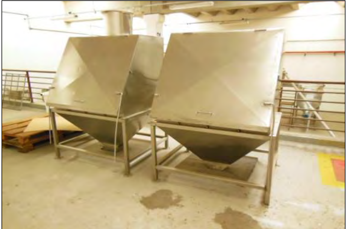
ITEM 1,003 / ITEM 1,004 – VISTA DO SILO I PARA ARMAZENAMENTO DE ACUCAR EM AÇO INOX COM VIBRADOR E DO SILO I PARA ARMAZENAMENTO DE CACAU EM AÇO INOX COM VIBRADOR
