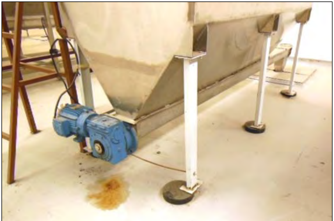
ITEM 1,032 – VISTA DO SILO FABRIMA I EM ALUMINIO COM ROSCA TRANSPORTADORA NA SAÍDA ACIONADO POR MOTOR REDUTOR
