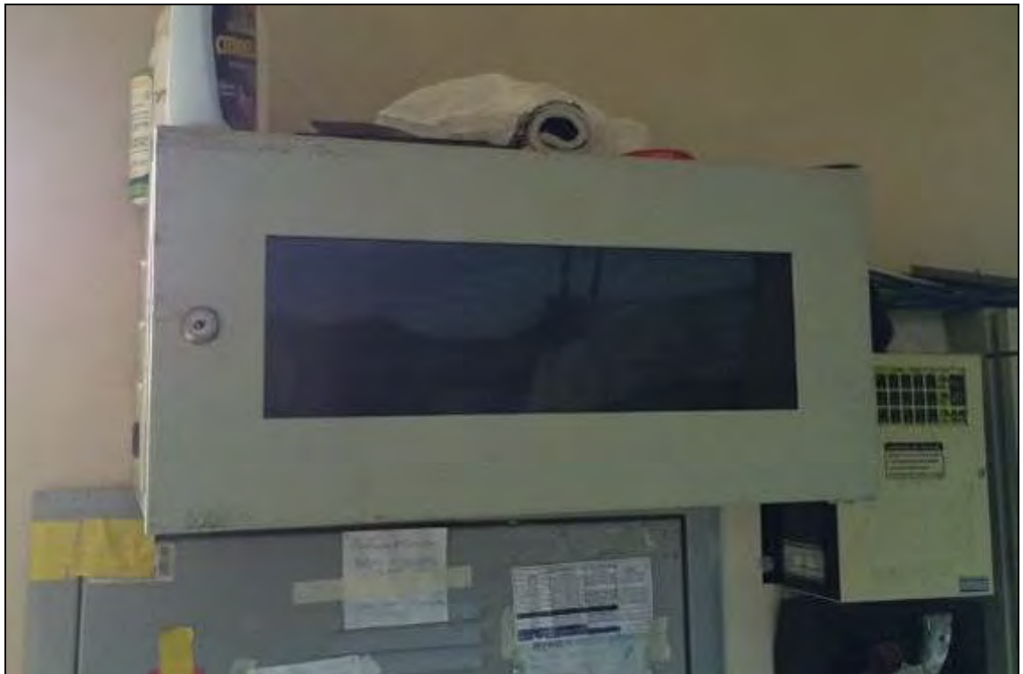
ITEM 2,245 – VISTA DA RACK METALICO PARA SWITCH
