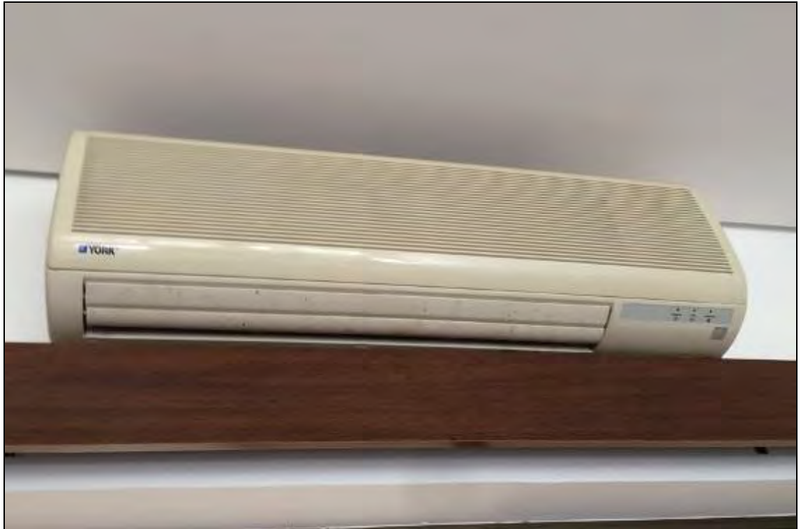
ITEM 2,201 – VISTA DO AR CONDICIONADO SPLIT MARCA: YORK
