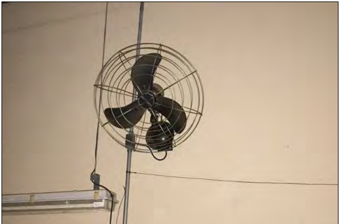
ITEM 2,344 – VISTA DO VENTILADOR DE PAREDE MARCA: VENTISILVA
