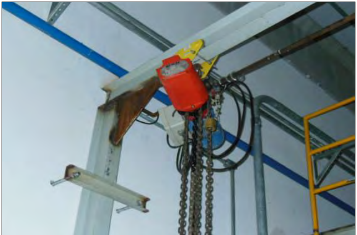
ITEM 1,069 – VISTA DA TALHA ELETRICA MARCA: KOCH
