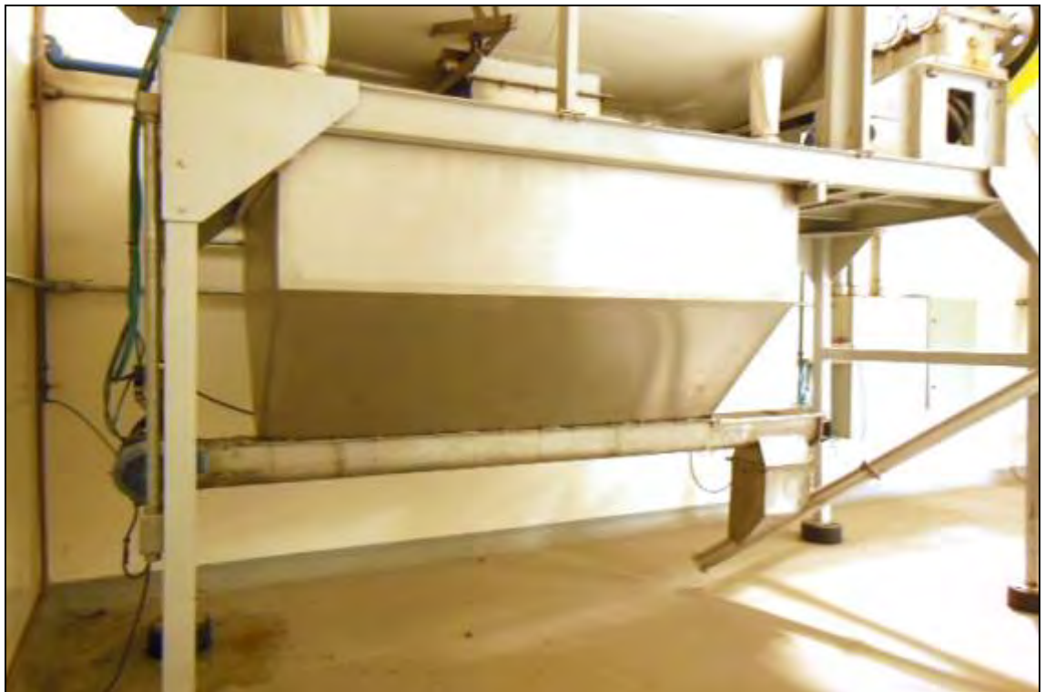
ITEM 1,006 – VISTA DA CAIXA COLETORA EM AÇO INOX COM ROSCA TRANSPORTADORA NA SAÍDA, ACIONADA POR MOTOR E REDUTOR
