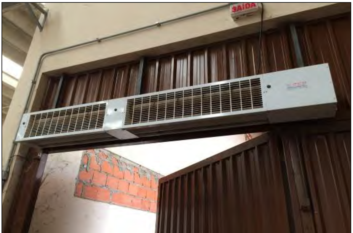
ITEM 2,206 – VISTA DA CORTINA DE AR
