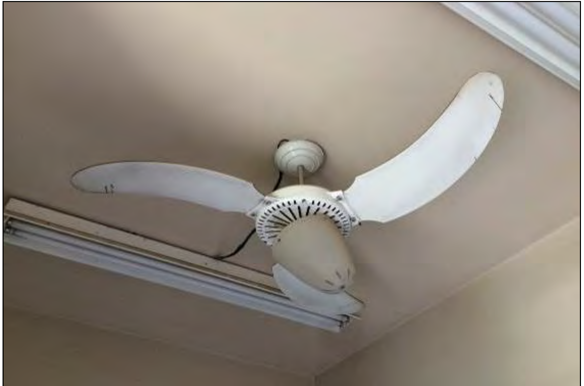
ITEM 2,248 – VISTA DO VENTILADOR DE TETO COM 3 PAS
