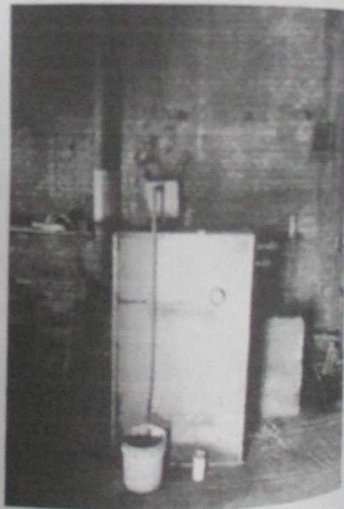
Sala da caldeira
