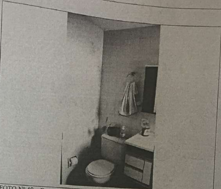
FOTO Nº 49 – Detalhe do Banheiro do Apartamento Nº 146. Nota-se seu estado de conservação e os diversos materiais de acabamento e construção.
