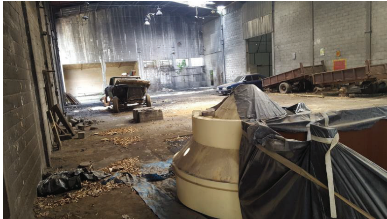
FOTO N° 12 Vista parcial interior galpão Fábrica 1 – péssimo estado geral de conservação
