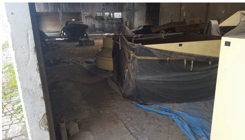
FOTO N° 14 Vista parcial detalhe piso danificado Fábrica 1
