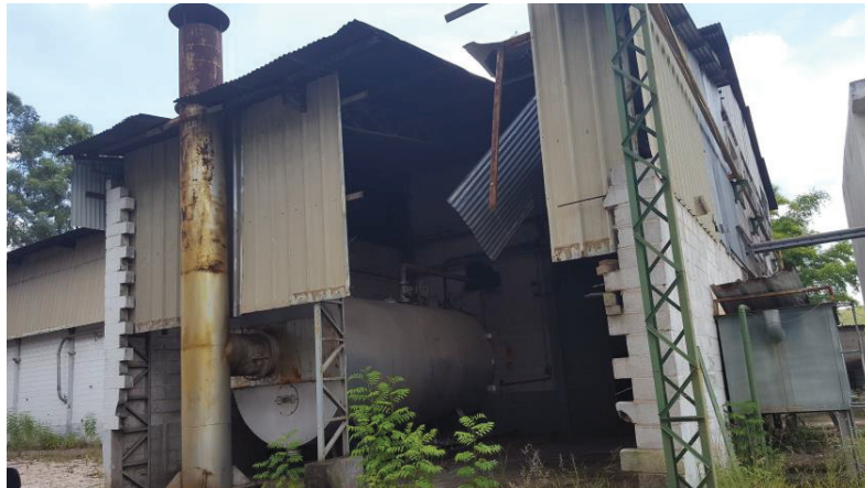
FOTO Nº 10 Vista parcial galpão Fábrica 1 – detalhe telhado e fechamento danificados
