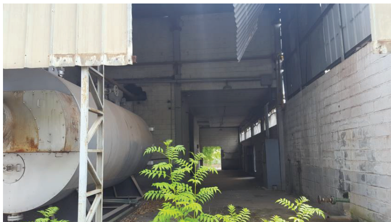
FOTO Nº 11 Vista parcial interior galpão Fábrica 1 – aparentando abandono
