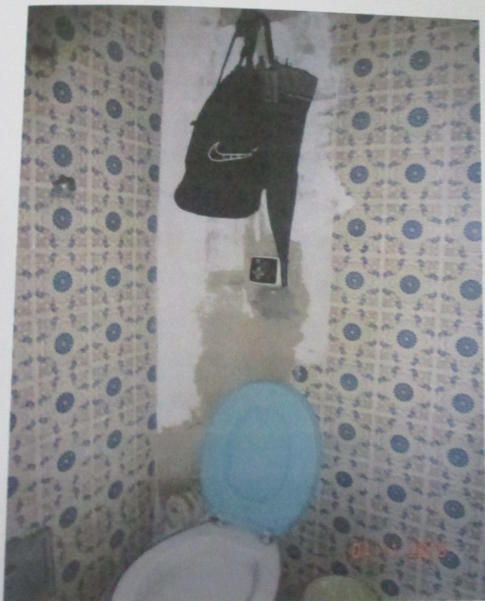
FOTO 26: Vista parcial do w.c. de serviço, observando-se vestígios que evidenciam a execução de nova argamassa na região da prumada.
