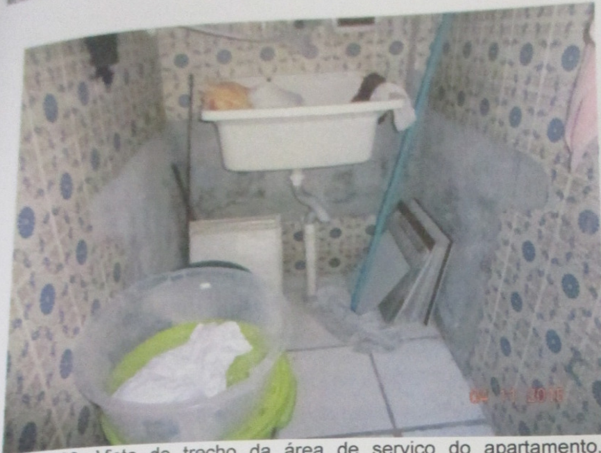
FOTO 23: Vista de trecho da área de serviço do apartamento, observando-se vestígios que evidenciam a execução de reparos de argamassa na região do entorno do tanque.
