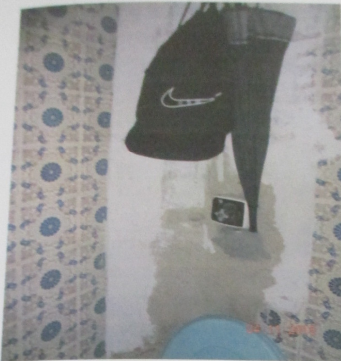
FOTO 27: Detalhe do trecho ilustrado na foto anterior, onde se observam reparos de argamassa na região da prumada junto à válvula de descarga.
