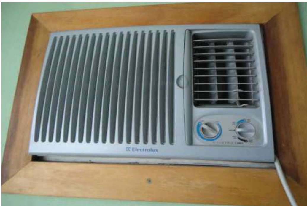
ITEM 2,023 - VISTA DO CONDICIONADOR DE AR MARCA: ELETROLUX MODELO: 7500 F VOLT: 220V
