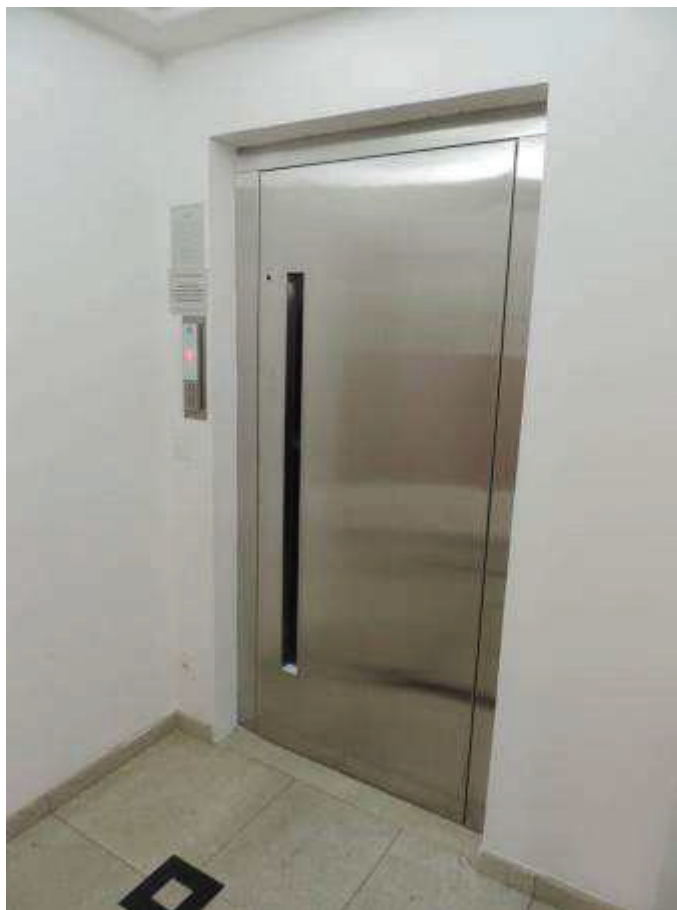
Foto nº. 6 – Vista do elevador localizado no hall social.
