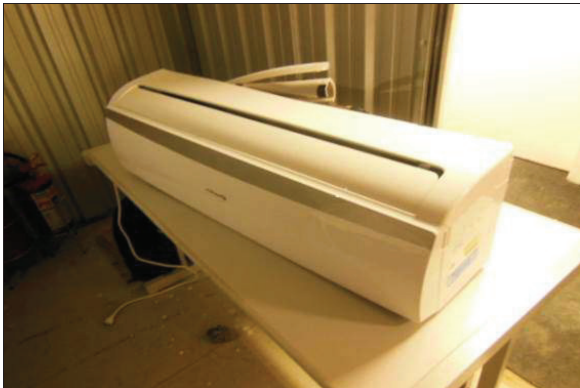
ITEM 1,013 – VISTA DO AR CONDICIONADO MARCA: SPRINGER CARRIER MODELO: SPLIT HI WALL POTÊNCIA: 22.000BTU SÉRIE: 42FNCA18S5
