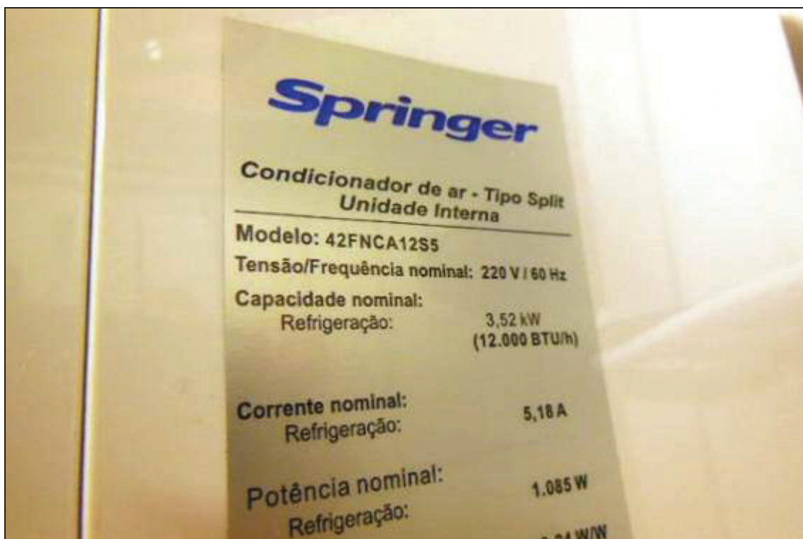
ITEM 1,011 – VISTA DA ETIQUETA DE IDENTIFICAÇÃO DO AR CONDICIONADO MARCA: SPRINGER CARRIER MODELO: SPLIT HI WALL POTÊNCIA: 12.000BTU SÉRIE: 42FNCA12S5
