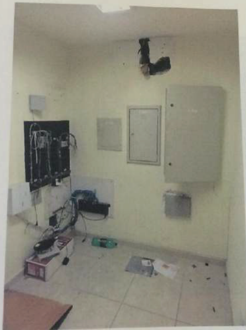
VISTA DA SALA DO SERVIDOR.
