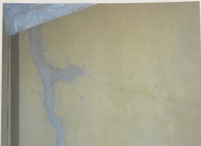
Foto 09 – Mostrando que nessa parede dos fundos, havia trincas estruturais, indicando má conservação do imóvel, o que foi considerado na avaliação.
