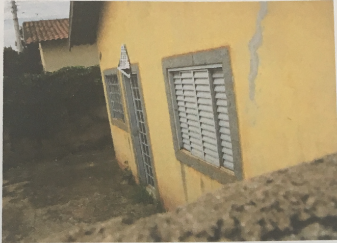
Foto 11 – Mostrando a parede frontal da casa, seu nível de construção do tipo popular e também a existência de trincas estruturais, indicando má conservação do imóvel.
