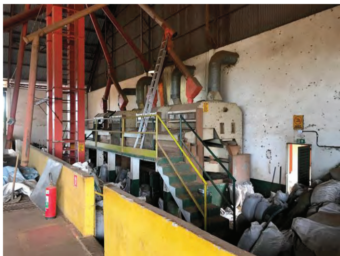
↑ Marquina de pré limpeza e elevador
