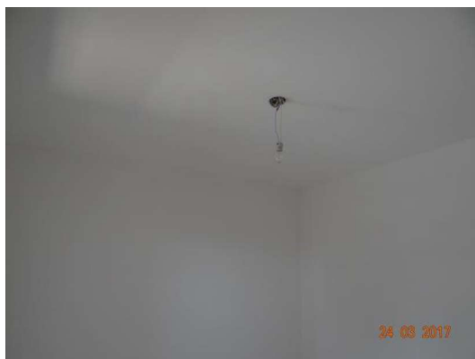
Piso superior: suíte e varanda padrão – piso em cerâmica, teto sem rodafeto
