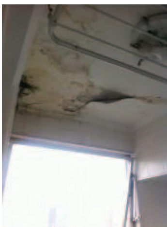
Foto 44: Teto da área de serviço com infiltração e descascamento da tinta de cobertura.
