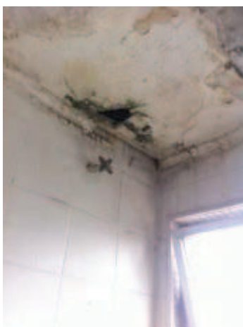
Foto 45: Teto da área de serviço com infiltração e descascamento da tinta de cobertura, descolamento do gesso e da laje superior.
