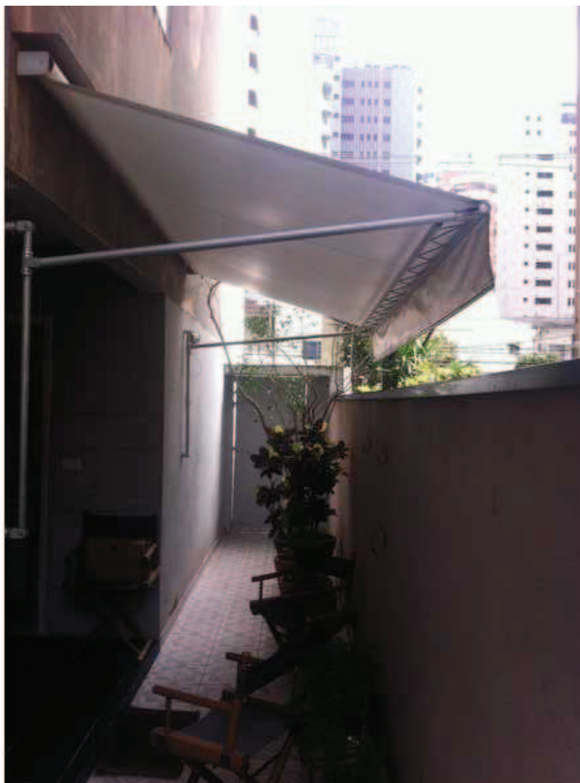
Foto 31: Detalhe do toldo da área exclusiva da unidade, com a porta de saída ao fundo. Esta porta é de uso apenas da unidade.
