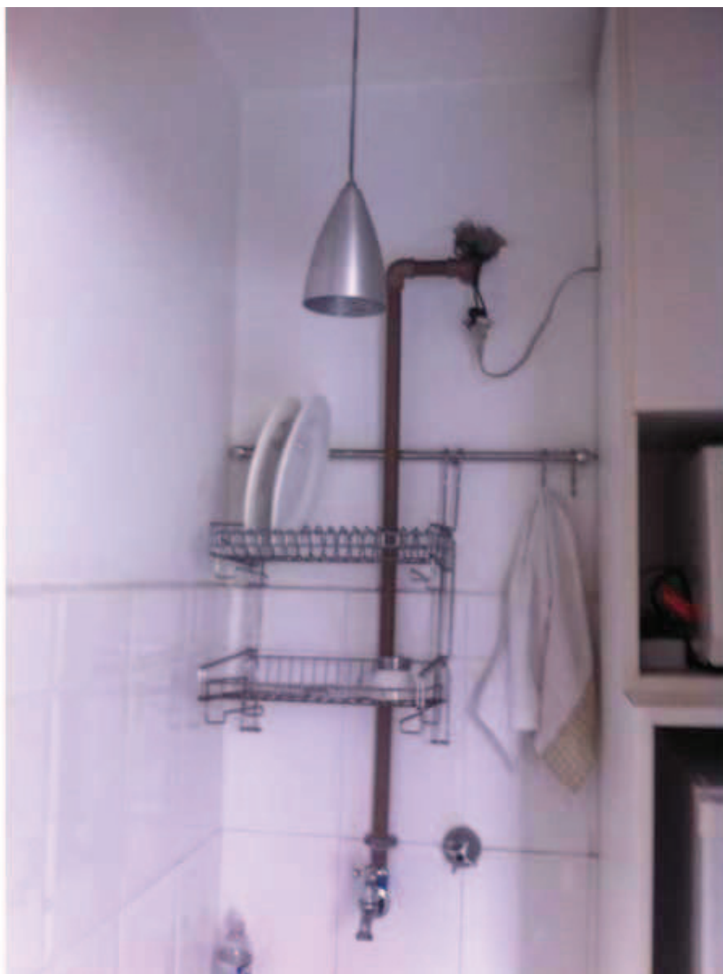
Foto 30: Detalhe do escorredor de louças, tendo tubulação aparente ao fundo, bem como fiação onde estão conectados o micro-ondas e a geladeira.
