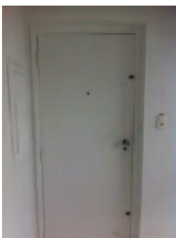
Foto 38: Porta da entrada de serviço.
