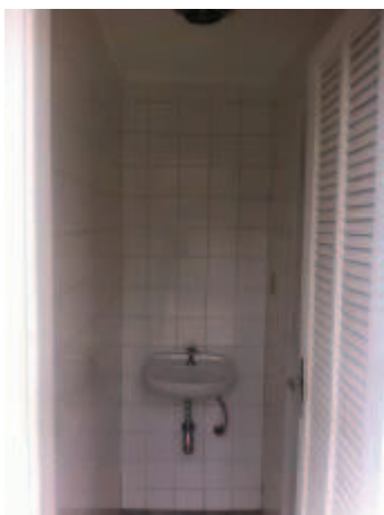
Foto 19: Lavatório do vestiário.
