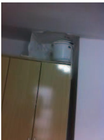
Foto 48: No detalhe, balde para coletar água que cai da laje e já provocou o descolamento da pintura do teto.
