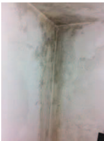
Foto 58: Detalhe do vazamento entre a parede e o teto do quarto 3.
