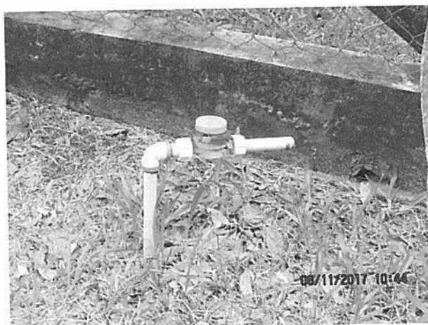
Vista de hidrômetro sem ligação de água para o imóvel
