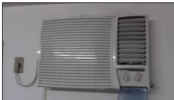
APARELHO DE AR CONDICIONADO
