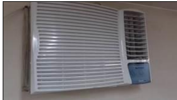
APARELHO DE AR CONDICIONADO
