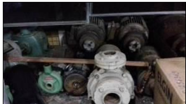
MOTORES ELÉTRICOS E BOMBAS
