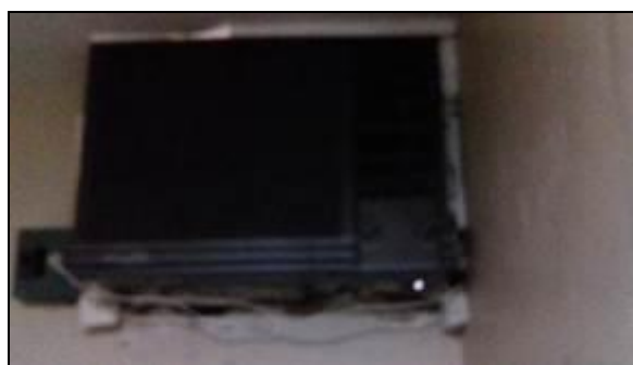
APARELHO DE AR CONDICIONADO
