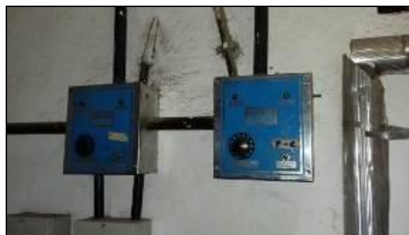
EQUIPAMENTOS DA SAUNA SODRAMAR
