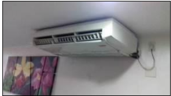
APARELHO DE AR CONDICIONADO
