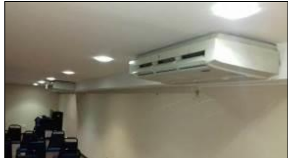
APARELHO DE AR CONDICIONADO
