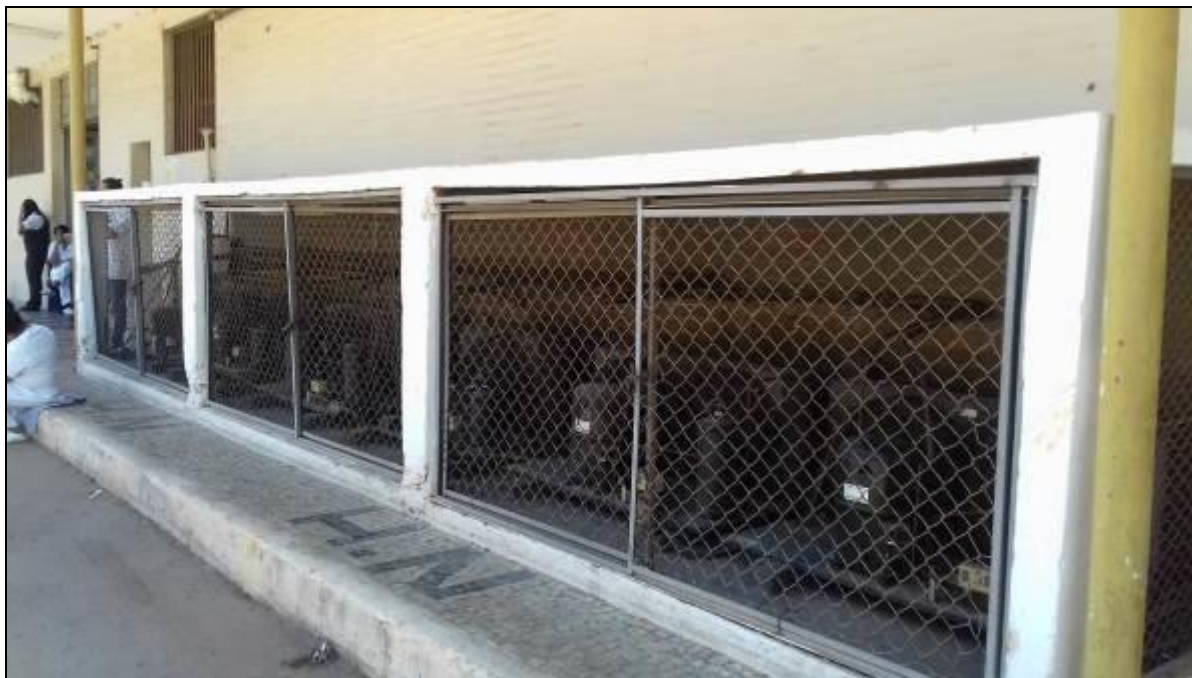
COBERTURA PARA COMPRESSORES DE REFRIGERAÇÃO
