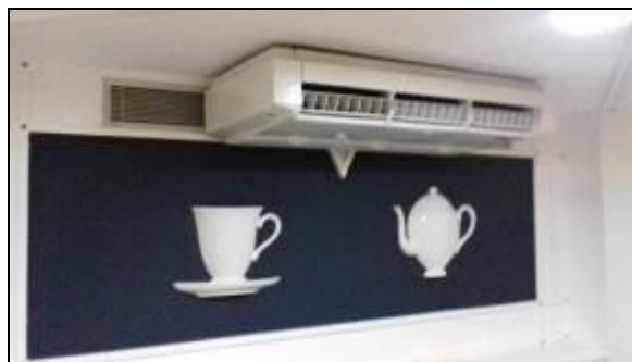
APARELHO DE AR CONDICIONADO
