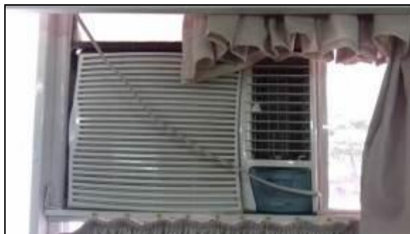
APARELHO DE AR CONDICIONADO
