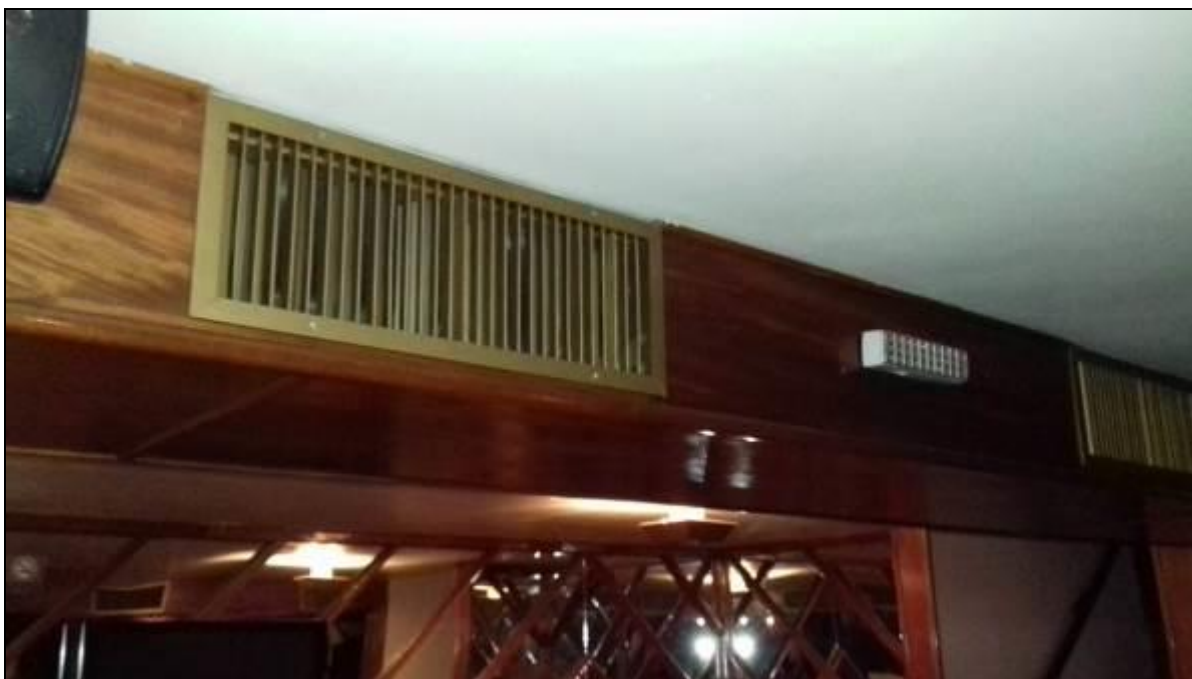
FORRO DA BOATE “NACIONAL MUSIC HALL” COM SAÍDAS DE AR CONDICIONADO CENTRAL
