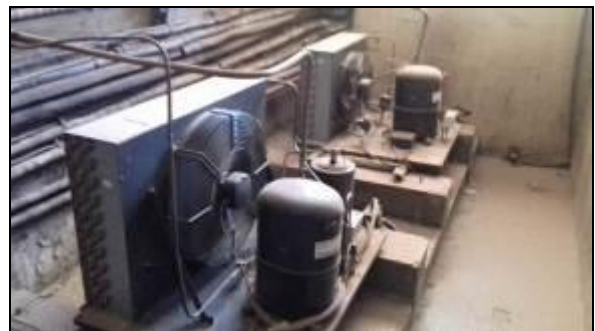
COMPRESSORES DE REFRIGERAÇÃO
