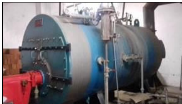
CALDEIRA A VAPOR TENGE
