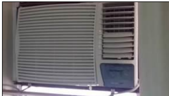
APARELHO DE AR CONDICIONADO
