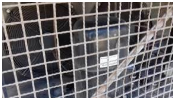
COMPRESSORES DE REFRIGERAÇÃO
