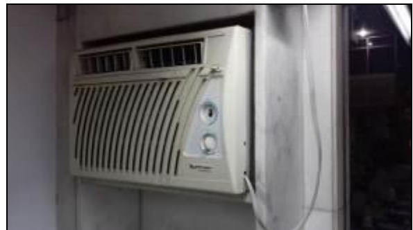
APARELHO DE AR CONDICIONADO
