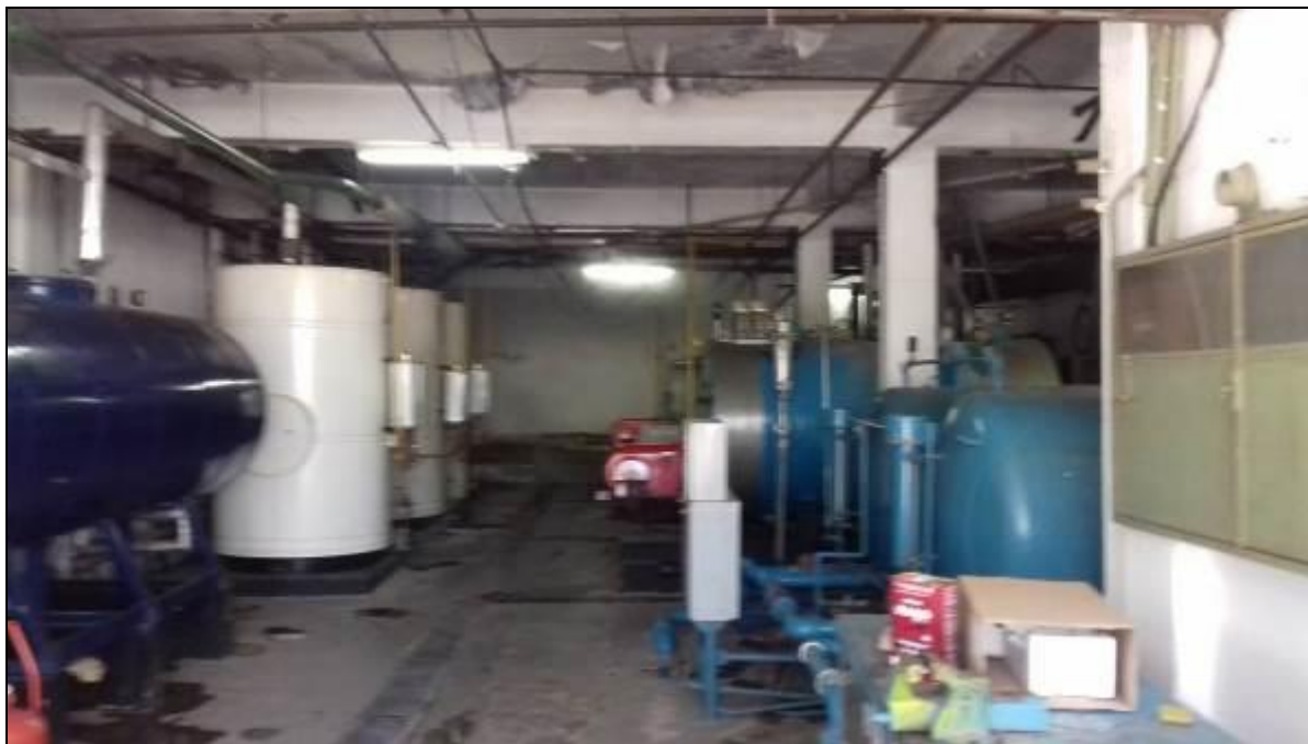
SALA DOS EQUIPAMENTOS MECÂNICOS
