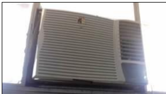
APARELHO DE AR CONDICIONADO
