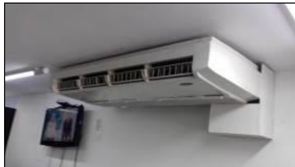
APARELHO DE AR CONDICIONADO
