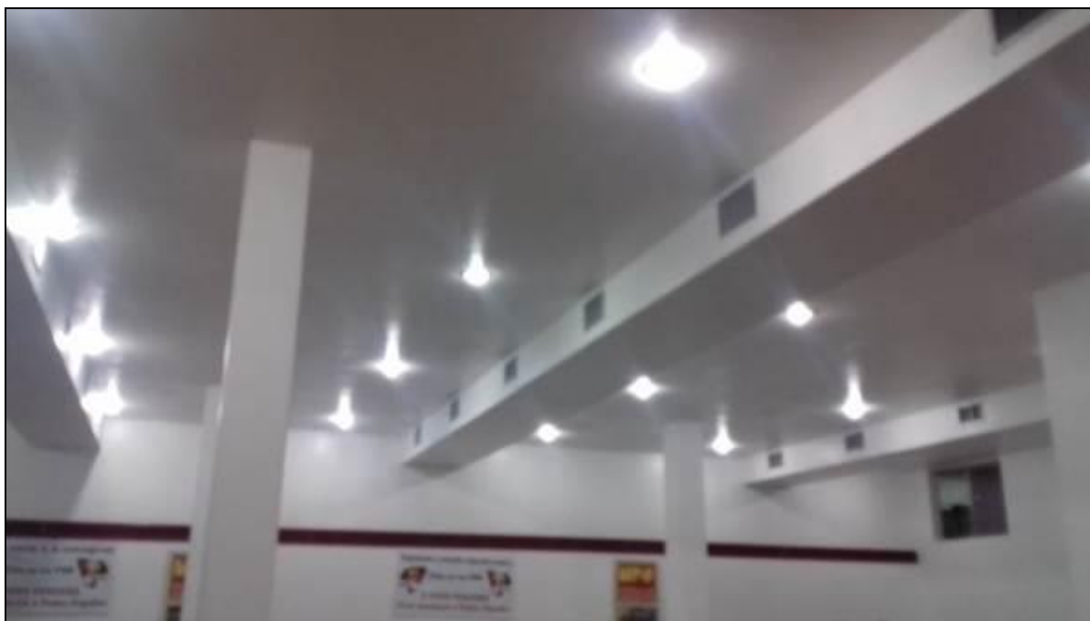
FORRO DO SALÃO DE CONVENÇÕES COM SAÍDAS DE AR CONDICIONADO CENTRAL
