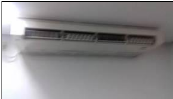
APARELHO DE AR CONDICIONADO
