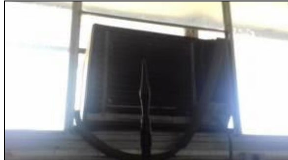
APARELHO DE AR CONDICIONADO
