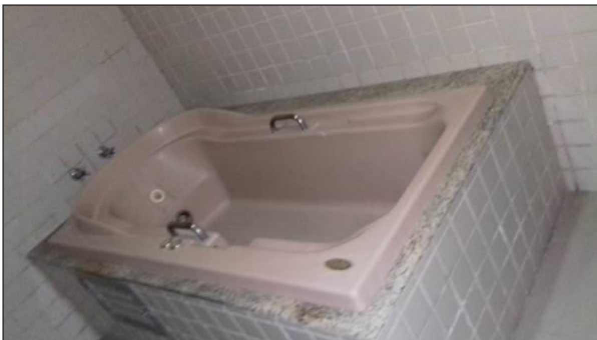
SALA DE HIDROMASSAGEM DA SAUNA
