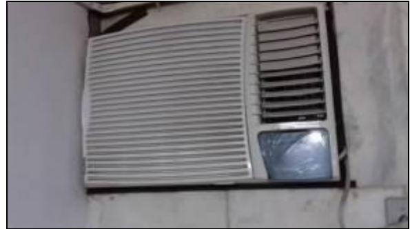
APARELHO DE AR CONDICIONADO
