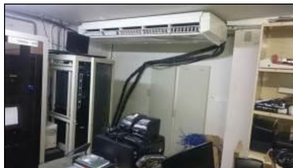
APARELHO DE AR CONDICIONADO
