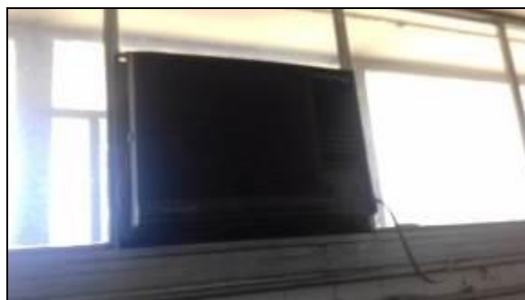
APARELHO DE AR CONDICIONADO
