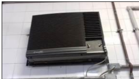
APARELHO DE AR CONDICIONADO
