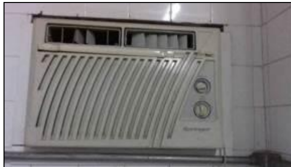
APARELHO DE AR CONDICIONADO
