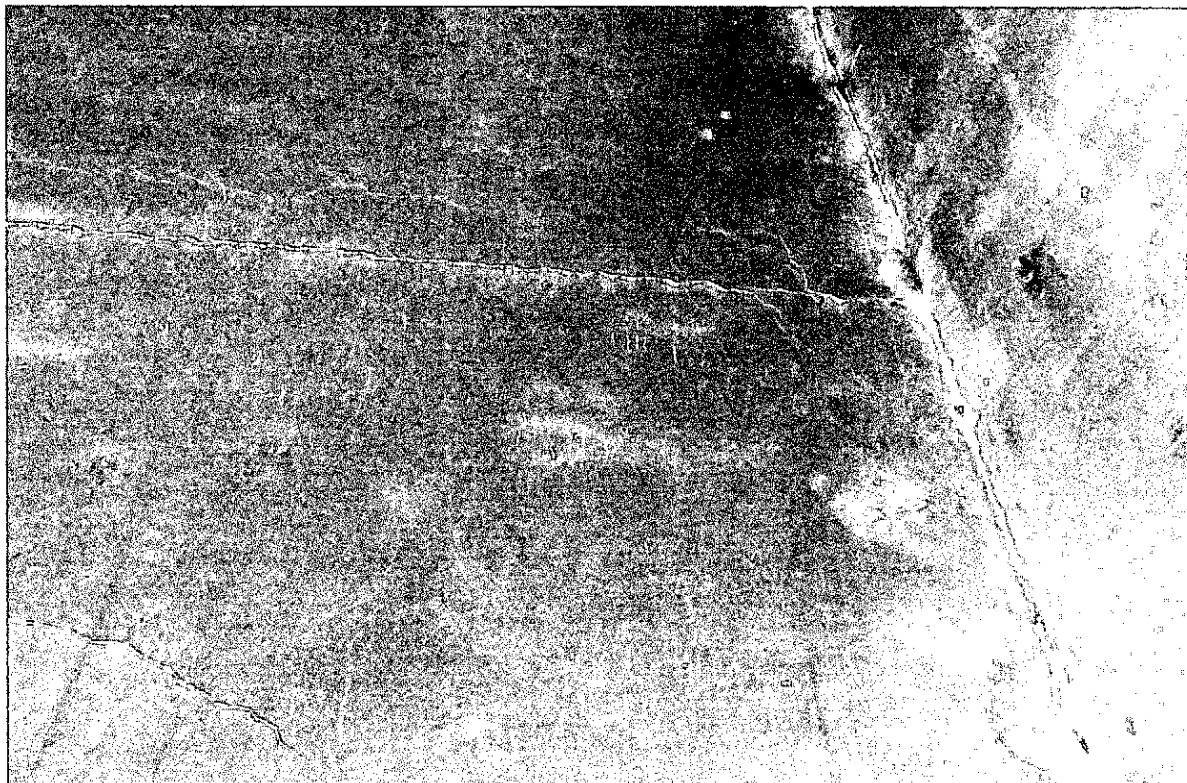
Imagem das trincas nas paredes do barracão após o incêndio
