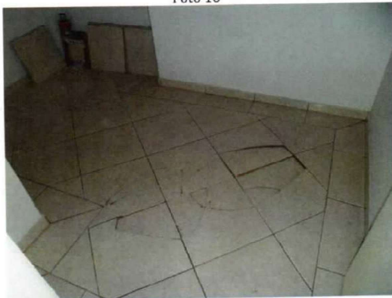
Danos no piso (detalhe)
