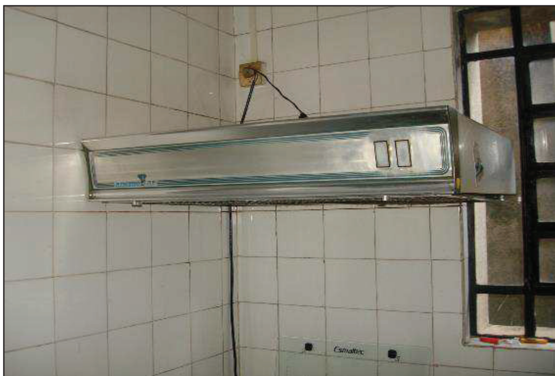
ITEM 2,237 - VISTA DA COIFA MARCA: ANEMOA
