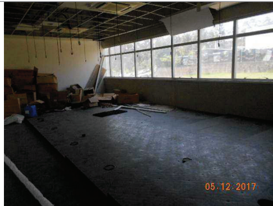
Sala do CPD com piso elevado
