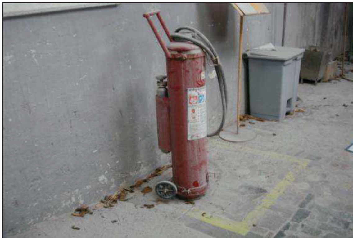
ITEM 5,009 - VISTA DO EXTINTOR
