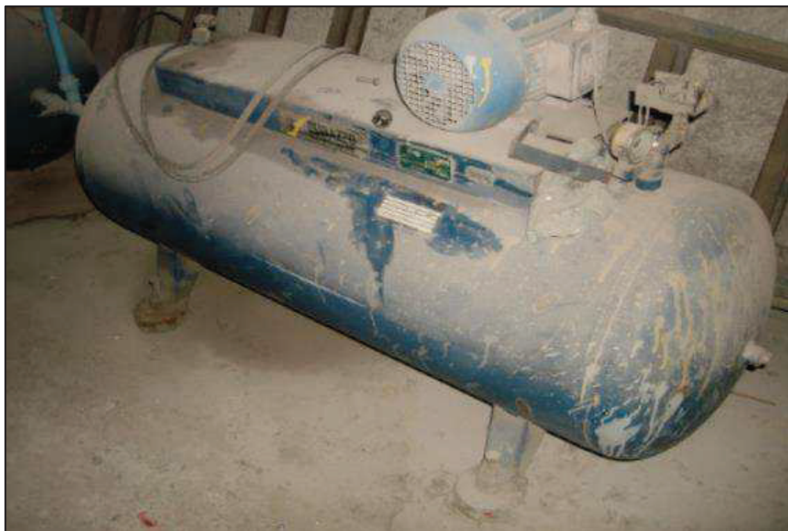
ITEM 1,058 - VISTA DO COMPRESSOR CAP: 150L MARCA: DURAZZO
