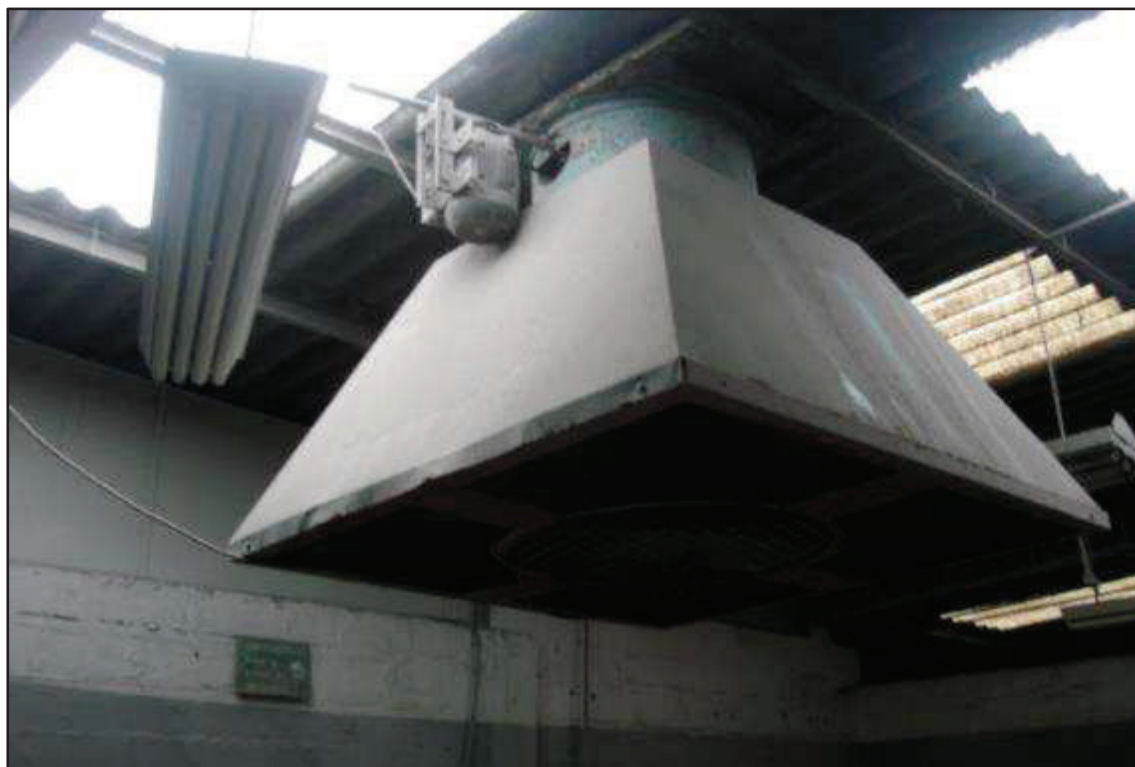
ITEM 1,095 - VISTA DO EXAUSTOR
