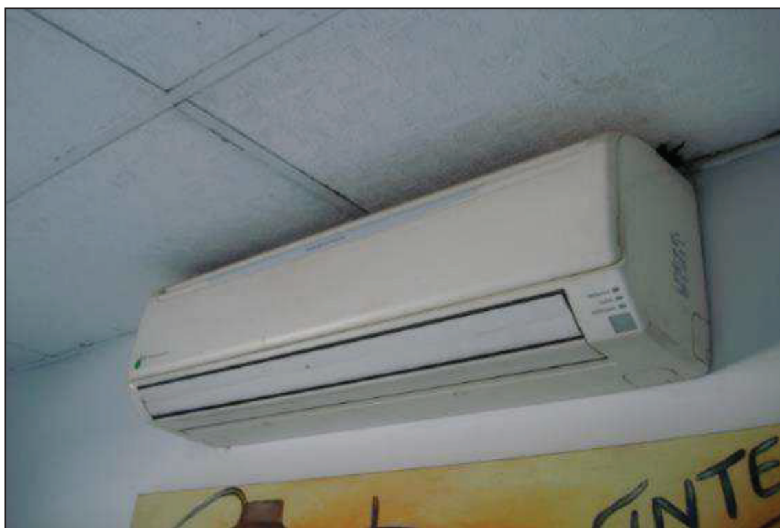
ITEM 2,114 - VISTA DO AR CONDICIONADO MARCA: FUJITSU
