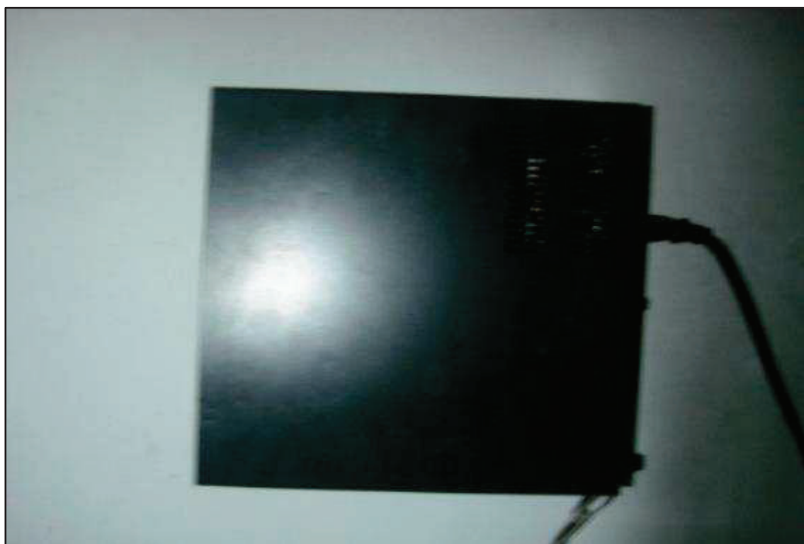
ITEM 3,079 - VISTA DO NOBREAK MARCA: SEIDEN
