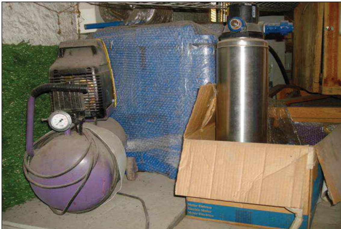
ITEM 1,096 - VISTA DO COMPRESSOR PORTÁTIL DE AR
