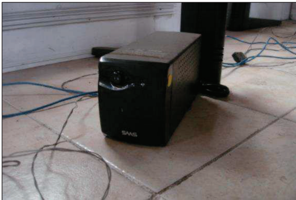
ITEM 3,080 - VISTA DO ESTABILIZADOR MARCA: SMS
