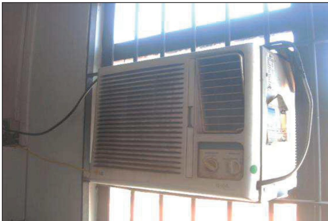
ITEM 2,102 - VISTA DO AR CONDICIONADO 7500 BTUS MARCA: LG MODELO: GOLD PROTECT WGM07 3FGA
