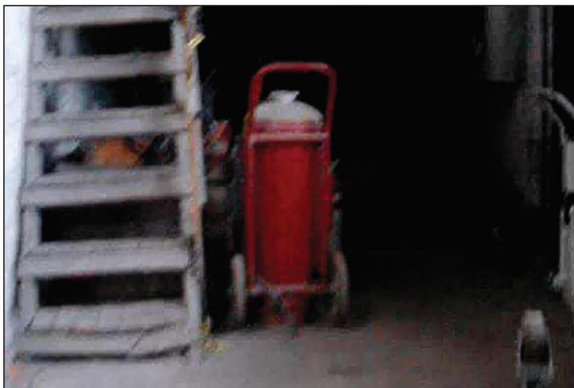
ITEM 5,010 - VISTA DO EXTINTOR AGUA 75 L
