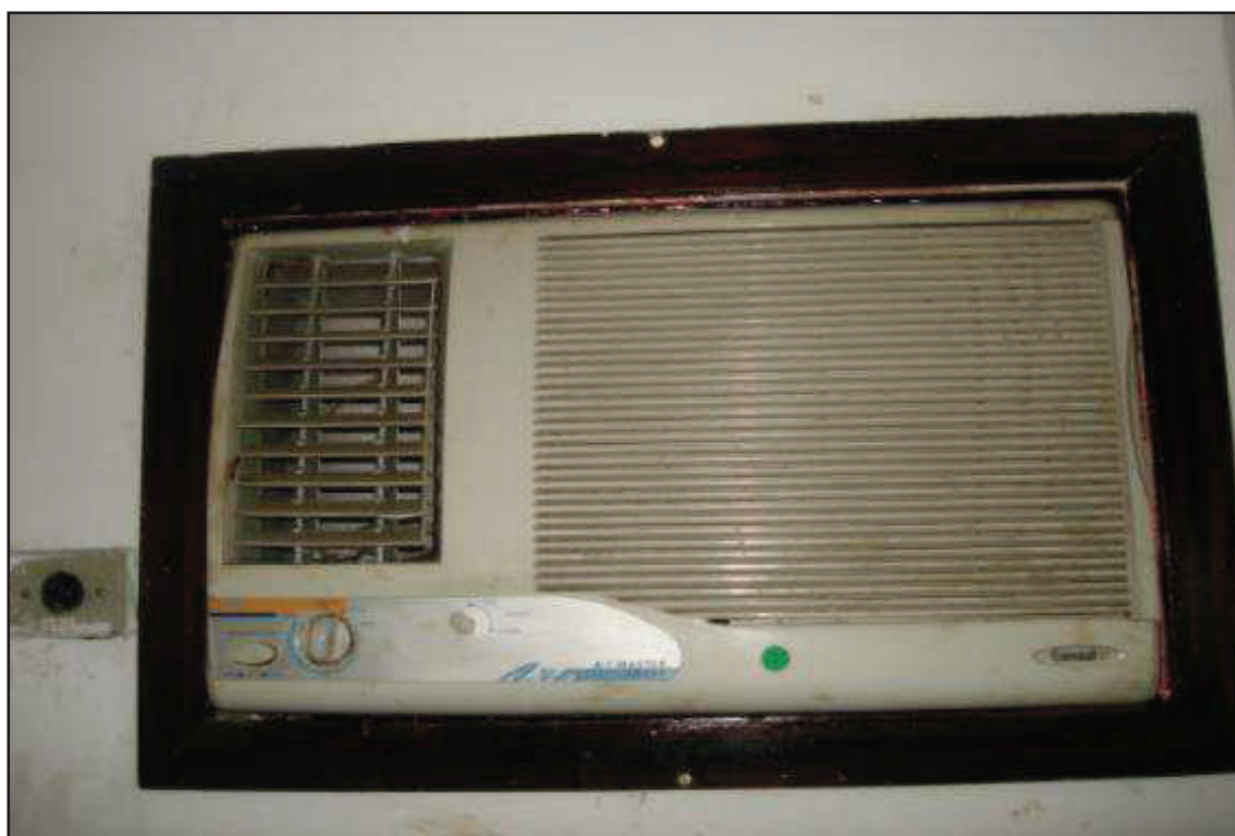
ITEM 2,107 - VISTA DO AR CONDICIONADO MARCA: CONSUL MODELO: AIR MASTER 1500
