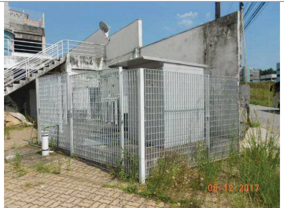
Cabine de Força e Gerador
