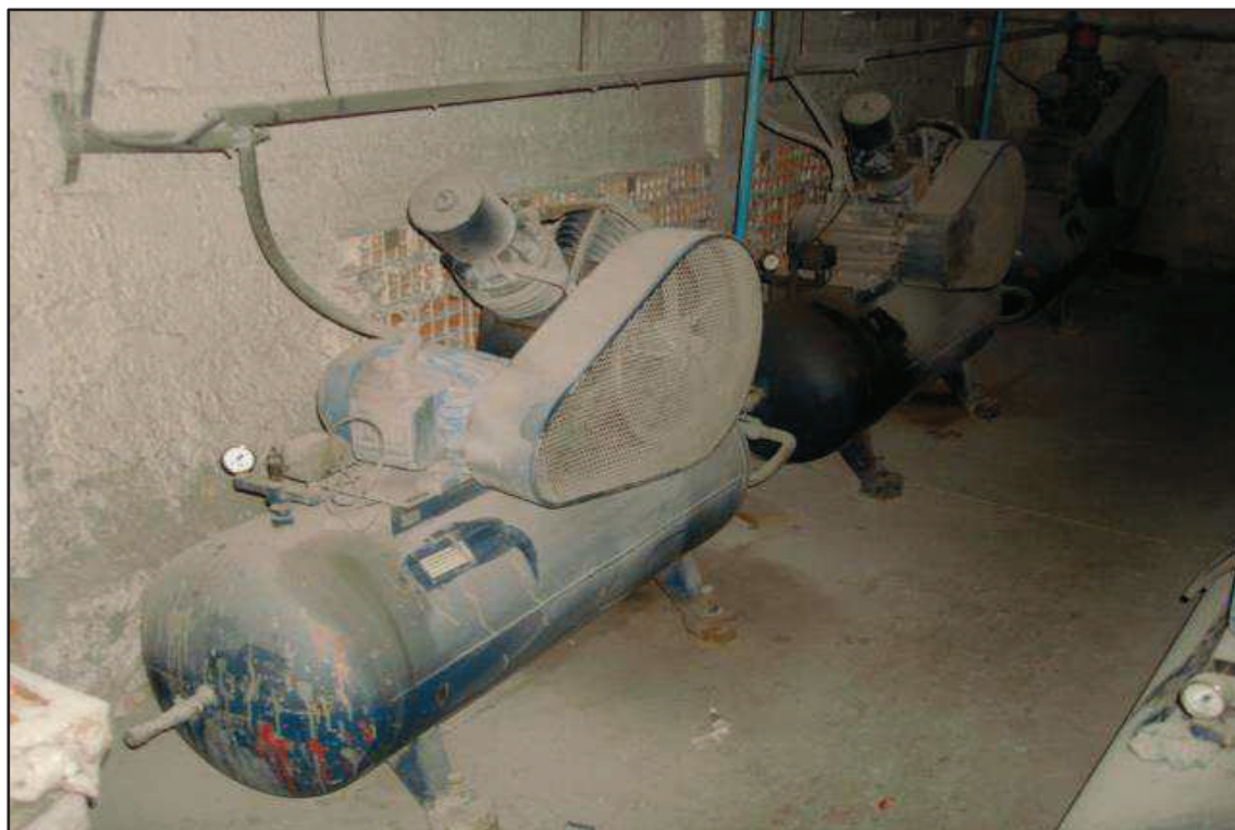
ITEM 1,057 - VISTA DO COMPRESSOR DE AR COMPRIMIDO CAP: 150L MARCA: WAYNE
