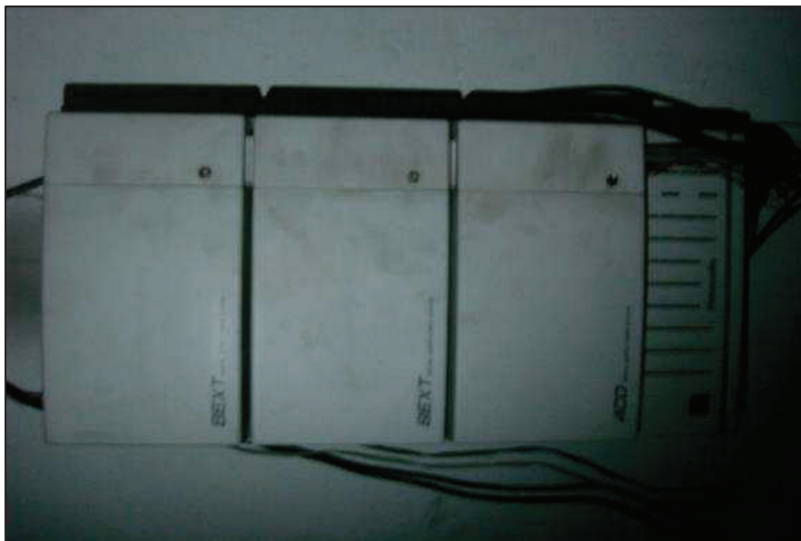
ITEM 3,043 - VISTA DA CENTRAL PABX MARCA: PANASONIC MODELO: KX COM 1 4CO E 2 BEXT
