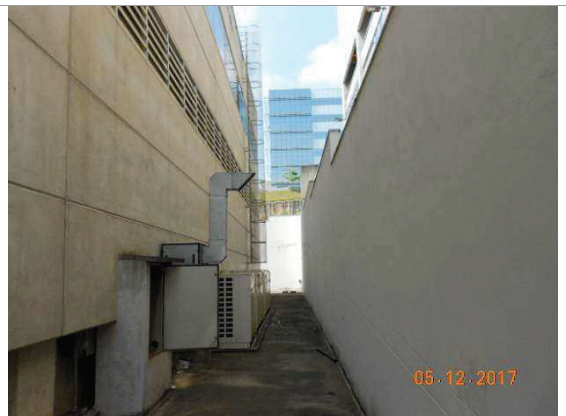
Máquinas de Ar Condicionado
