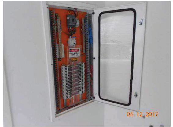
Quadro de distribuição "fiação furtada"
