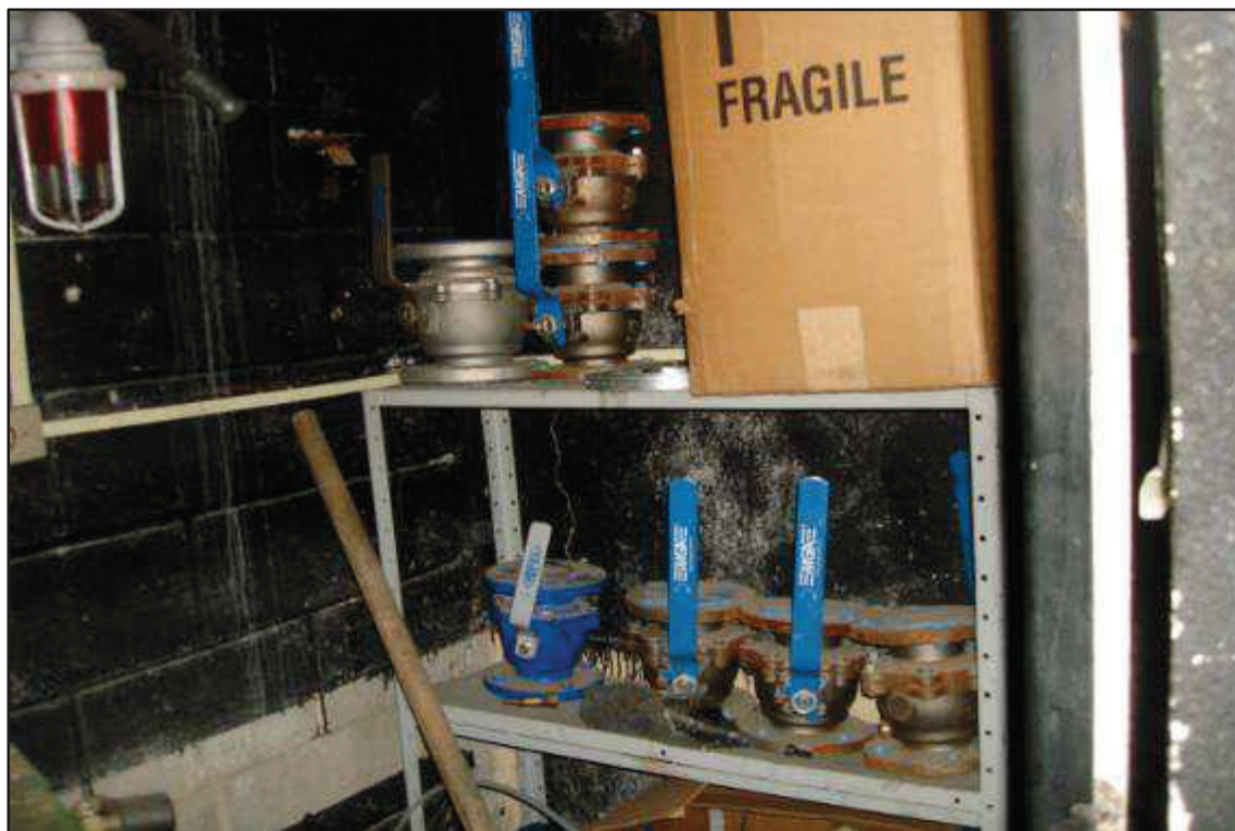
ITEM 5,347 - VISTA DA VÁLVULA ESFÉRICA
