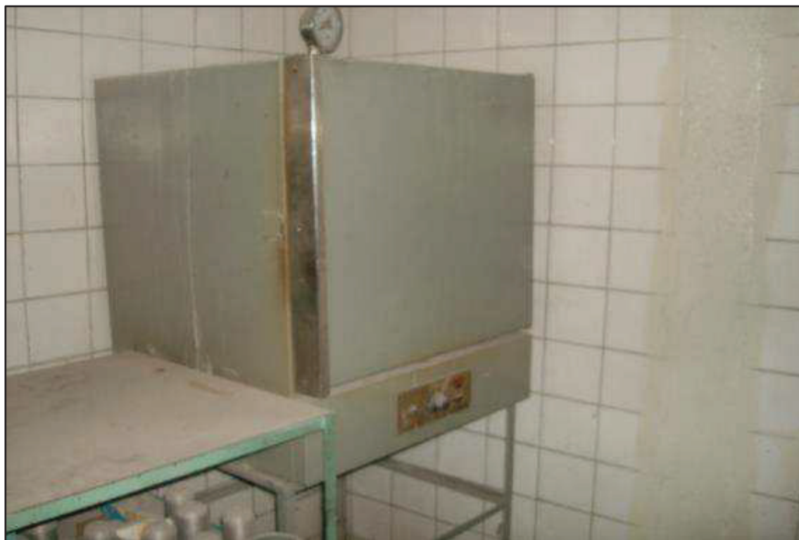
ITEM 1,023 - VISTA DA ESTUFA INDUSTRIAL MARCA: FABBE
