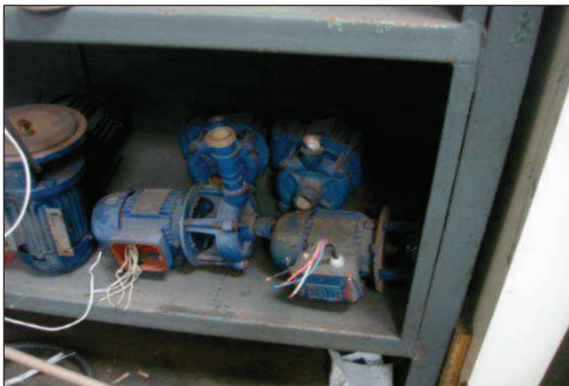
ITEM 1,073 - VISTA DA BOMBA CENTRIFUGA COM MOTOR ELÉTRICO MARCA: WEG
