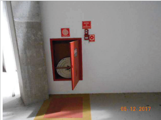
Sistema de incêndio
