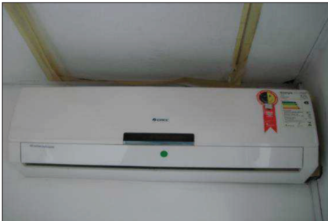
ITEM 2,105 - VISTA DO AR CONDICIONADO SPLIT 12000 BTU MARCA: GREE MODELO: GWC12MB-D1NNA3C
