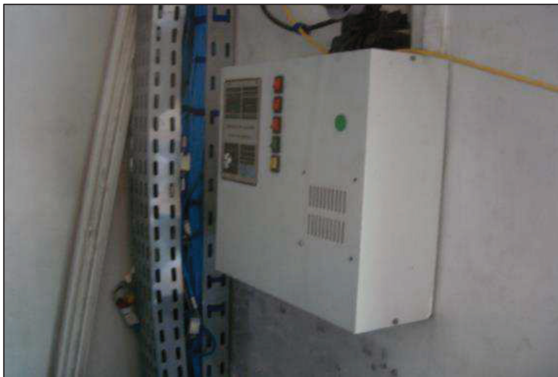
ITEM 3,012 - VISTA DA CENTRAL DE ALARME MODELO: EG800P
