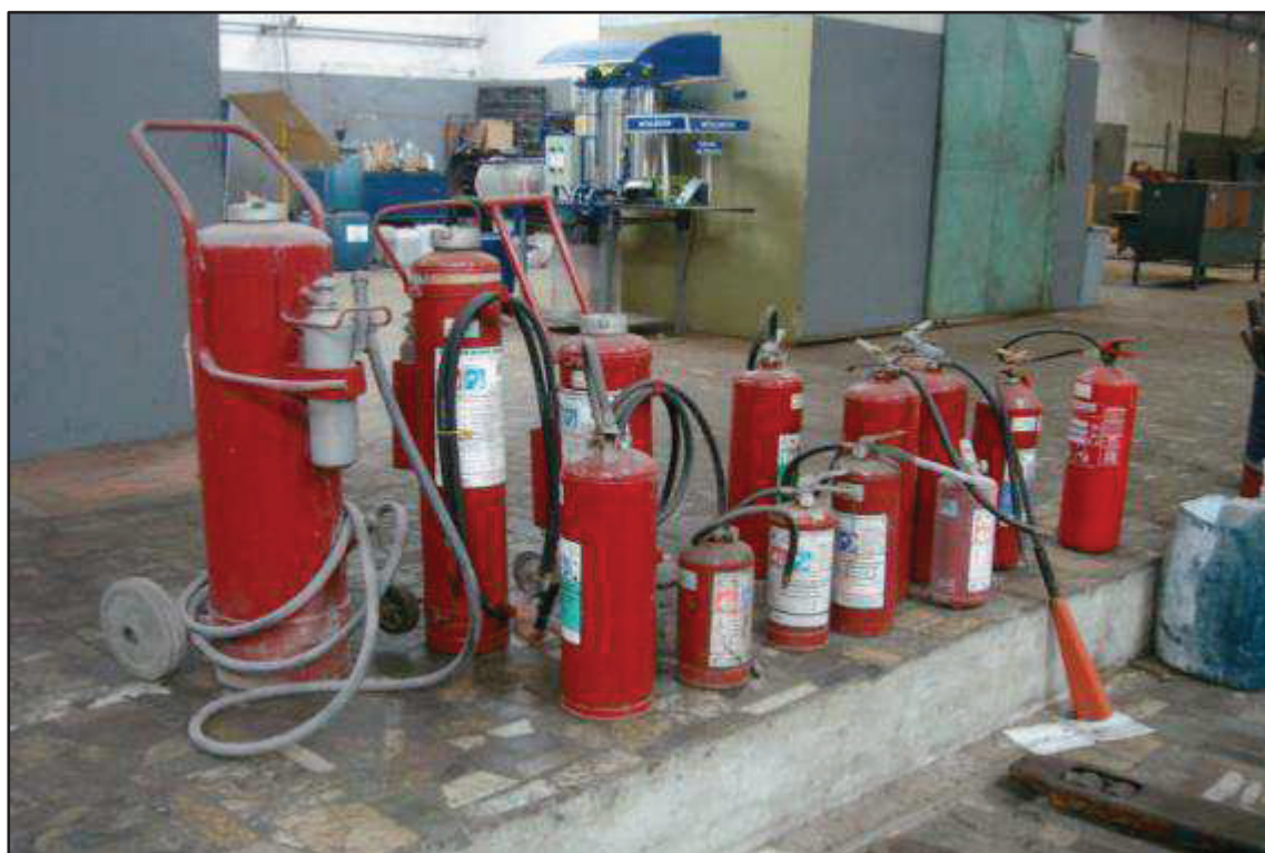
ITEM 5,008 - VISTA DOS EXTINTORES
