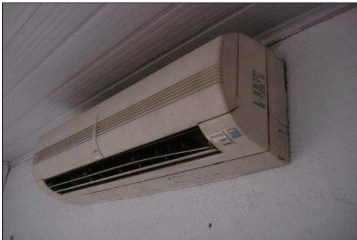
ITEM 2,239 - VISTA DO AR CONDICIONADO MARCA: MOMECO
