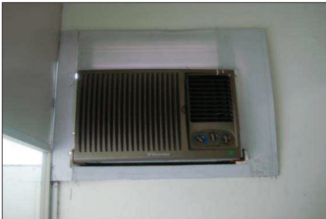
ITEM 2,113 - VISTA DO AR CONDICIONADO MARCA: ELECTROLUX MODELO: CICLOFRIO 10000F
