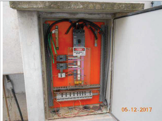
Quadro de entrada de energia "fiação furtada"
