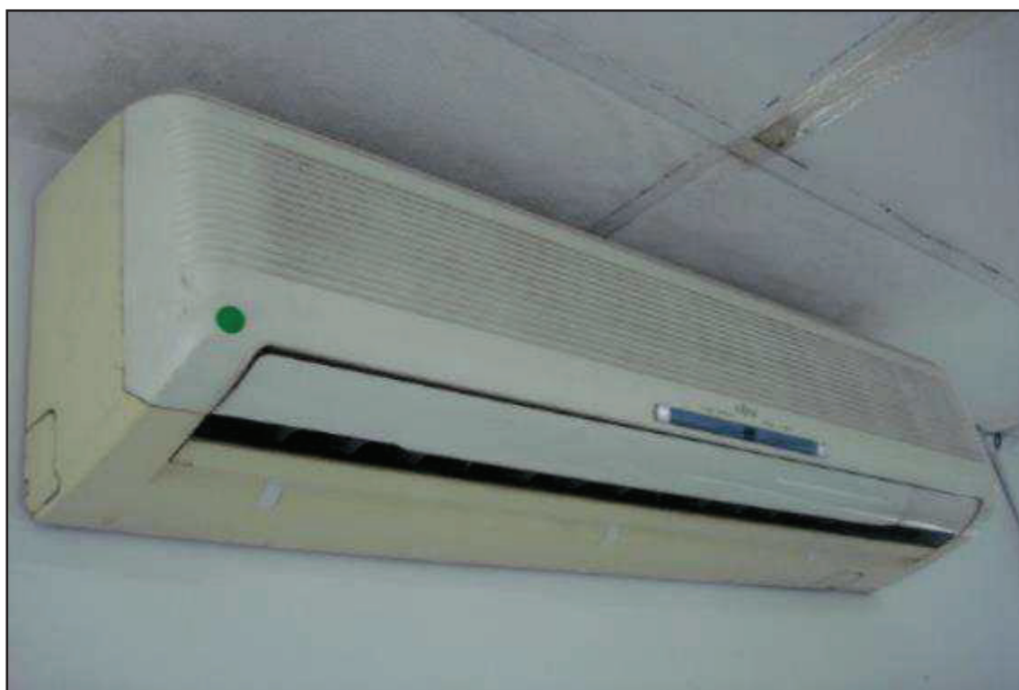
ITEM 2,103 - VISTA DO AR CONDICIONADO SPLIT MARCA: FUJITSU
