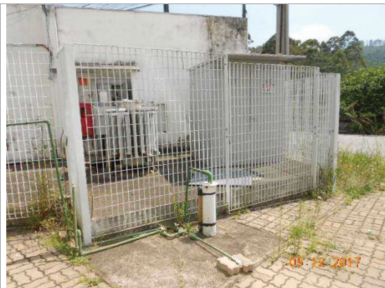
Cabine de Força e Gerador
