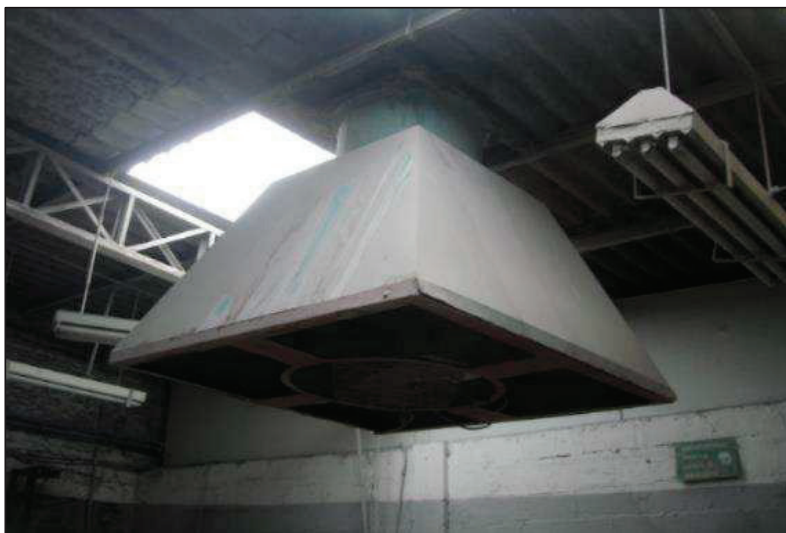
ITEM 1,095 - VISTA DO EXAUSTOR
