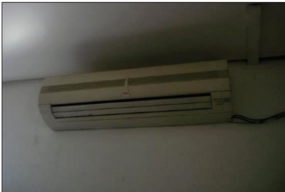
ITEM 2,101 - VISTA DO AR CONDICIONADO MARCA: FUJITSU
