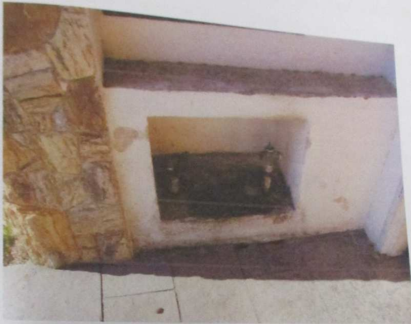
Vista do cavalete de água sem o relógio medidor
