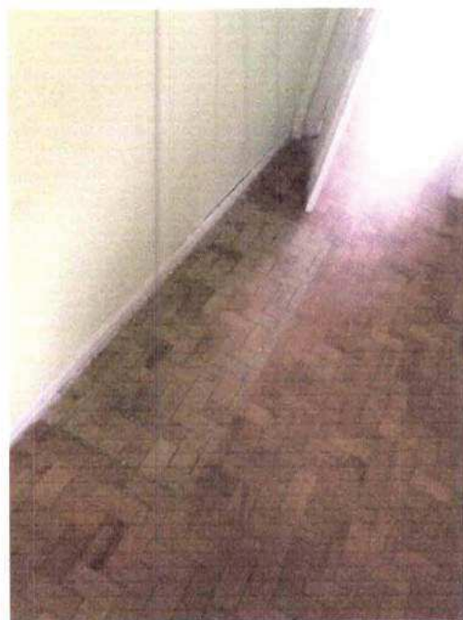
FOTO 44 – Quarto 4 – taco danificado
