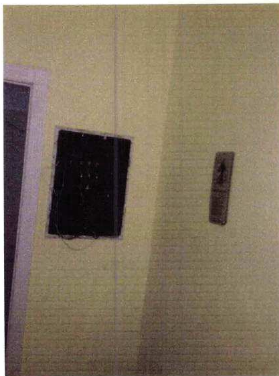
FOTO 52 – Quarto 6 – quadro de entrada de energia
