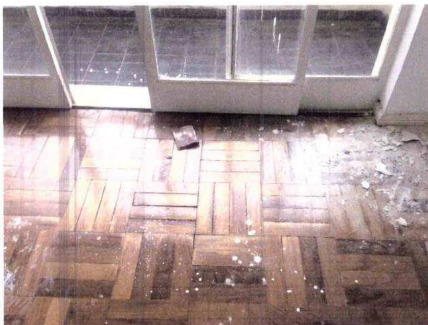
FOTO 32 – Sala Íntima – tacos danificados por umidade
