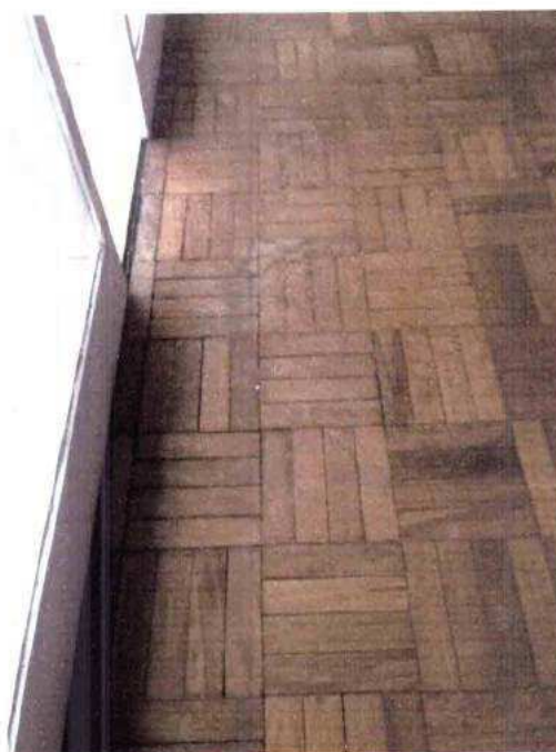
FOTO 04 – Piso de taco danificado por umidade
