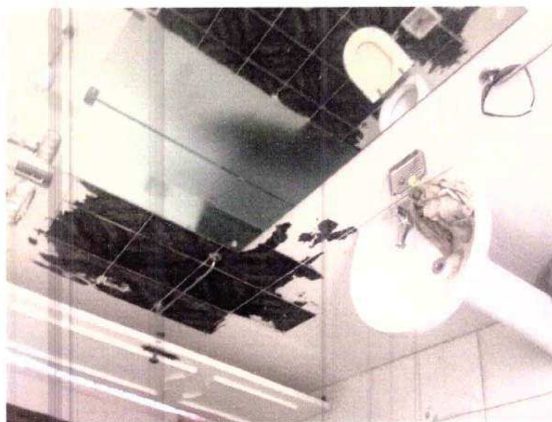
FOTO 46 – Banheiro 2 – pintura sobre azulejos descascando
