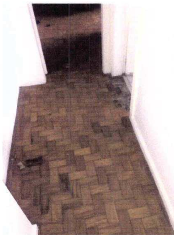
FOTO 26 – Hall Banheiro 1 – tacos soltos
