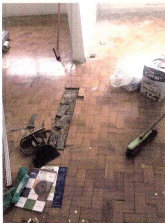
FOTO 40 – Quarto 3 – tacos soltos
