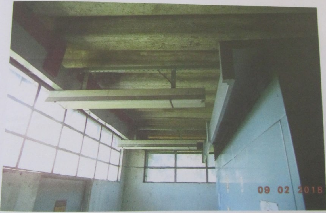
Foto 39 - Prédio 6 - Interior da Cabine Primária
