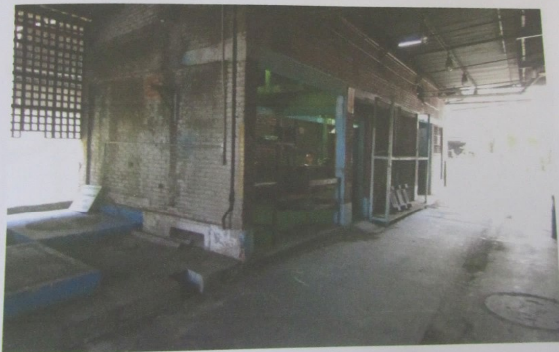
Foto 41 - Prédio 7 - Compressores e Lavagem de Tinteiros
