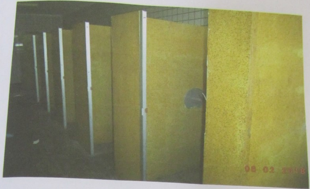
Foto 11 - Pavimento Térreo - WC Feminino
