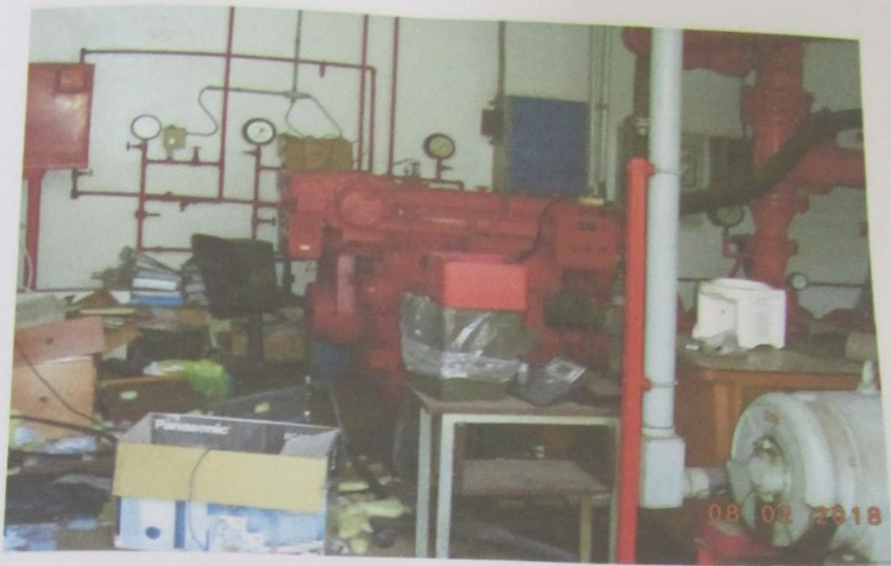
Foto 53 - Prédio 11 - Interior da Casa de Bombas
