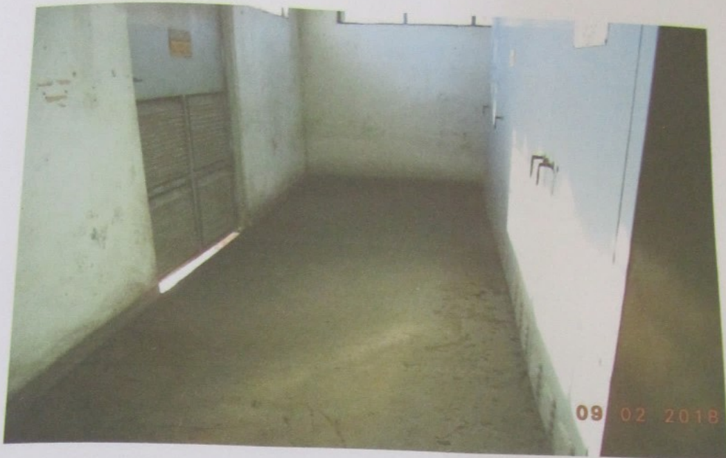
Foto 38 - Prédio 6 - Interior da Cabine Primária
