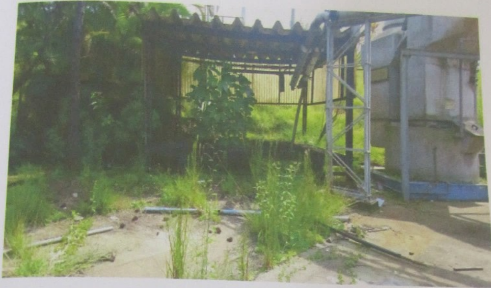
Foto 75 - Prédio 21 - Compressores de Refrigeração
