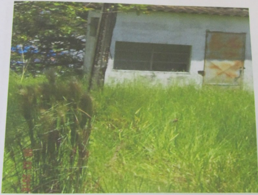
Foto 66 - Prédio 16 - Poço Artesiano - Casa do Painei
