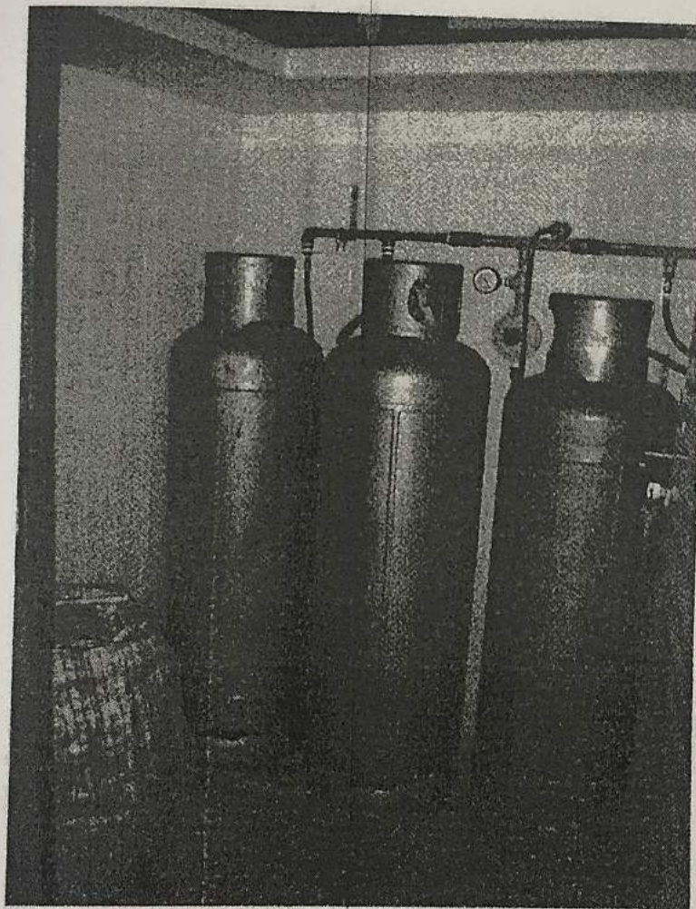
FOTO 42: CENTRAL DE GÁS.
