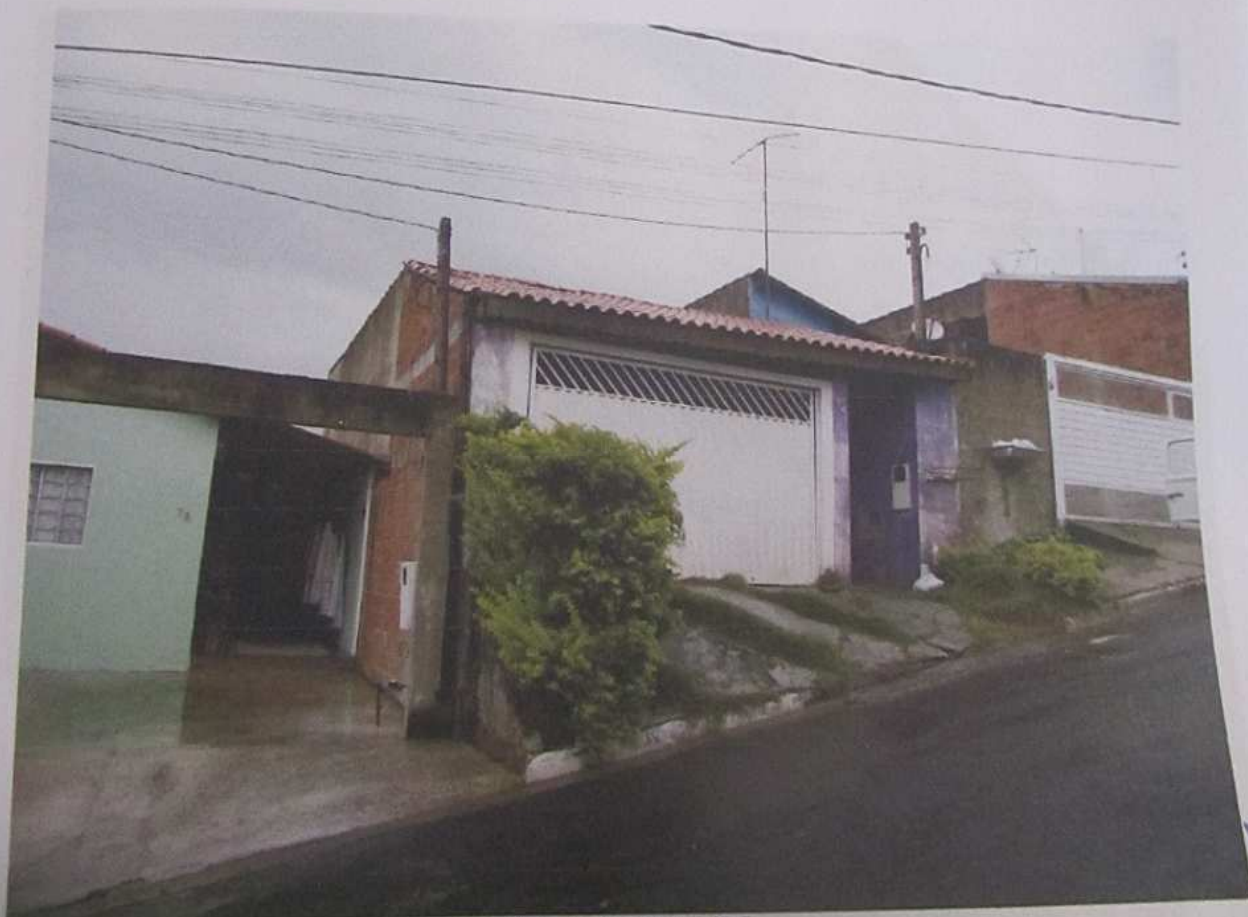
04 - DSCF6507.JPG Vista lateral esquerda do avaliando. Observa-se que a alvenaria lateral da garagem não tem revestimento externo. Calçada do imóvel em concreto apresentando-se fraturado.
