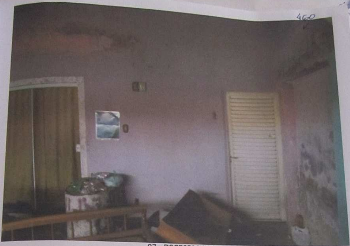
07 - DSCF6512.JPG Parede lateral direita com manchas de infiltração pela ausência de revestimento externo.
