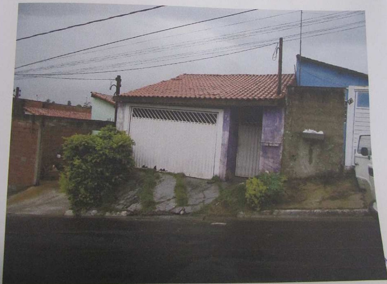
02 - DSCF6506.JPG Imóvel avaliando com numero predial 74. Observam-se algumas telhas deslocadas, pintura desgastada, portão com corrosão e buracos.
