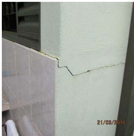
Foto 30.illustra Parede com trinca.
