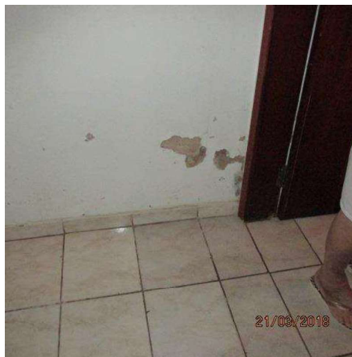
Presença de umidade nas paredes.
