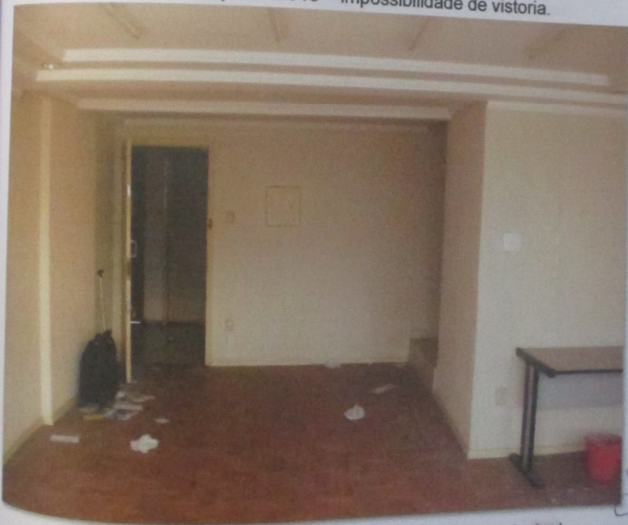
Foto nº 12 – Unidade similar ao conjunto 2.913 – sala principal.
