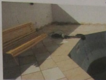
Vista da viela invasão de 0,50 metros da piscina e o filtro
