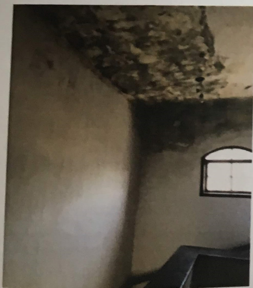
Marcas de infiltrações no teto do corredor do pavimento superior
