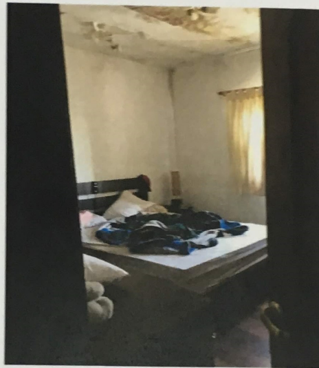
Dormitório suíte com marcas de infiltração no teto
