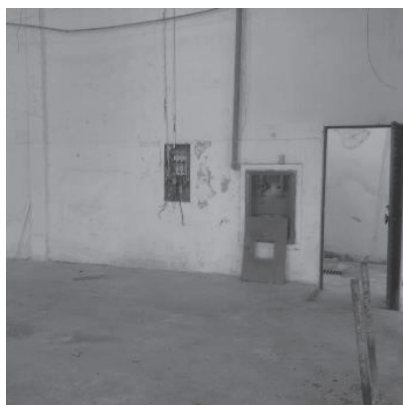
Detalhe – instalações danificadas
