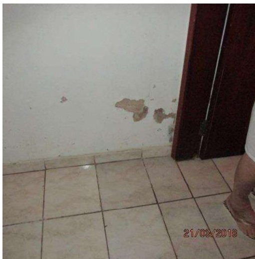
Presença de umidade nas paredes.
