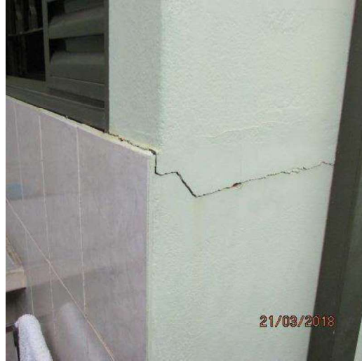
Foto 30. ilustra Parede com trinca.
