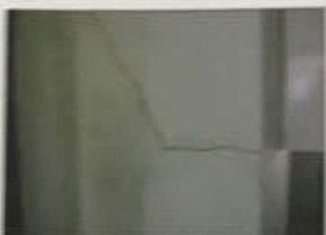
Foto 47: Trinca e infiltração
