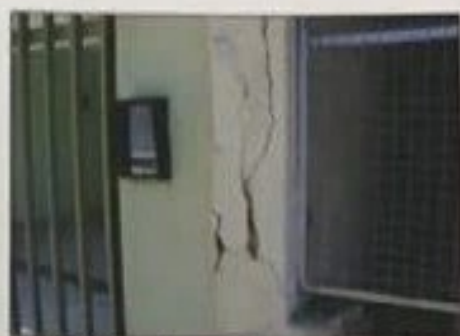
Foto 24: Detalhe de trincas na fachada
