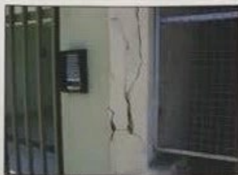
Foto 24: Detalhe de trincas na fachada
