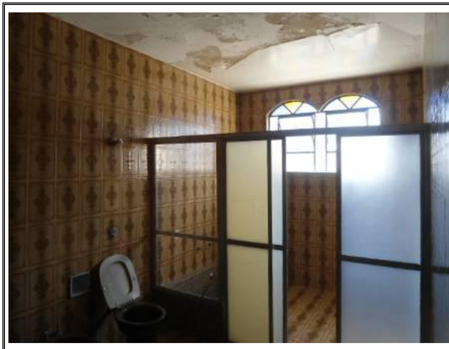
FOTO 15 - VISTA PARCIAL DO WC SUÍTE
