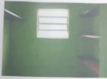
FOTO Nº 57 - Vista parcial interna do depósito da casa do caseiro. Nota-se as características físicas da construção.
