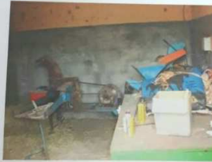
FOTO Nº 44 – Vista parcial interna do depósito da cocheira. Nota-se as características físicas da construção.
