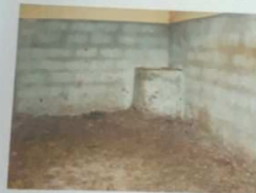
FOTO Nº 42 - Outra vista parcial interna da sala. Nota-se as características físicas da construção.
