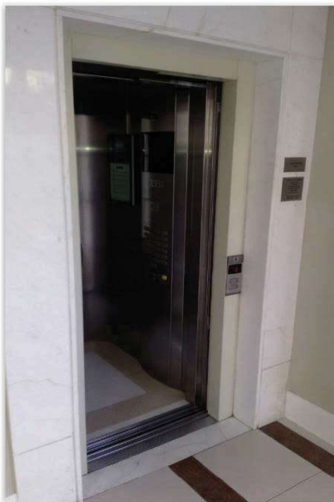
Foto 28 - Vista do elevador social na área comum do Condomínio.
