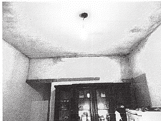
Foto 22: Vista teto da cozinha
