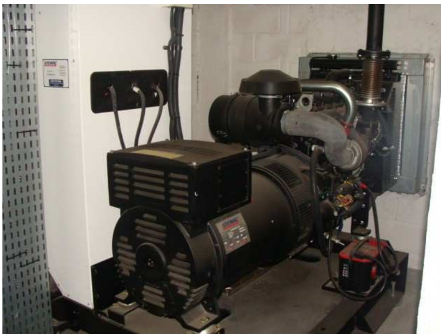
Foto 16. Vista parcial do gerador.
