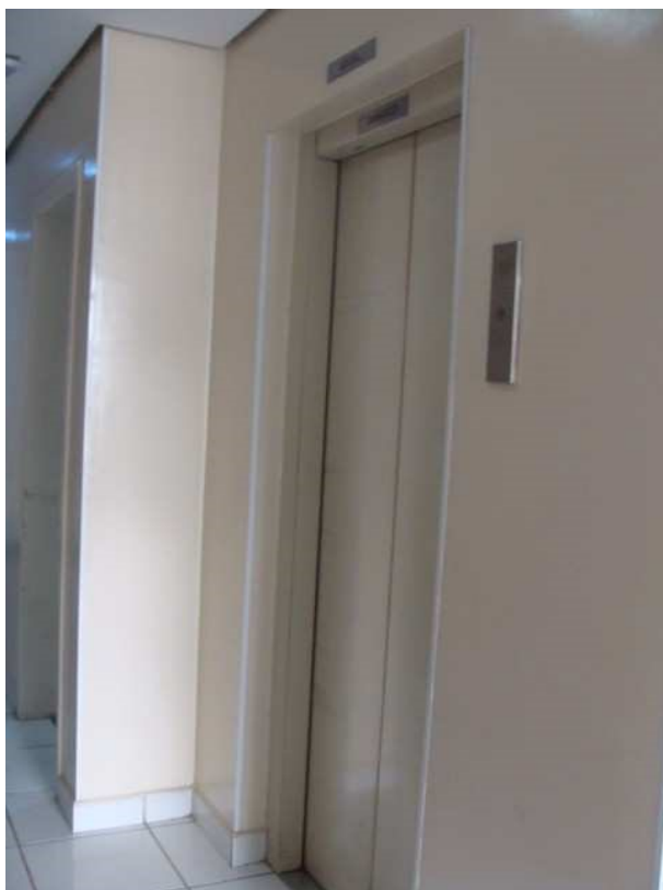
Foto 18. Vista parcial do elevador da Torre 2.
