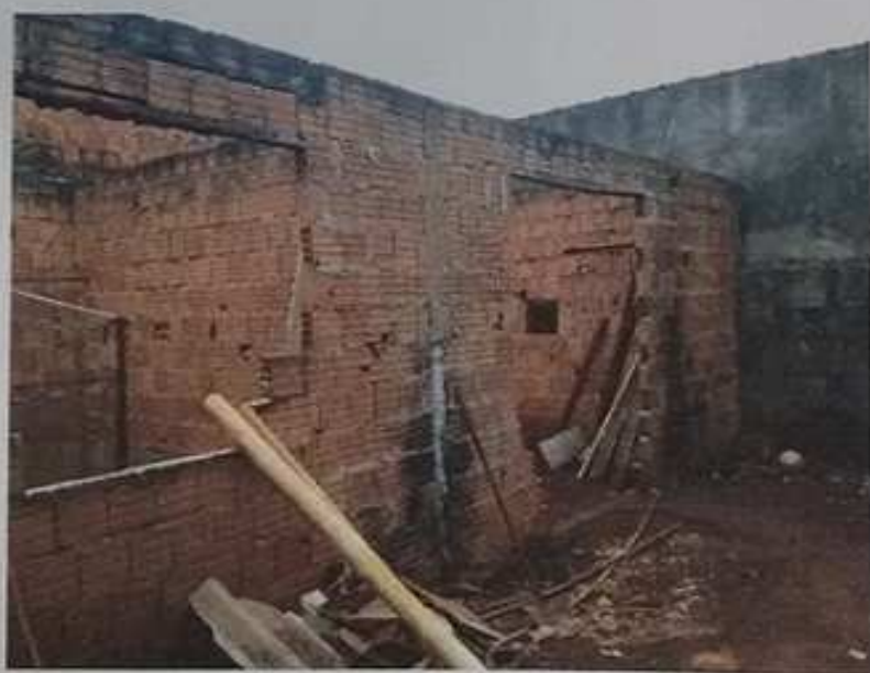
Foto 8 – Vista do benfeitoria não finalizada e sem valor comercial
