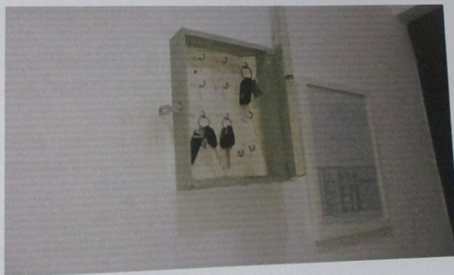
Foto – Quadro do mapa e caixa de chaves na parede do elevador, corredor da garagem.
