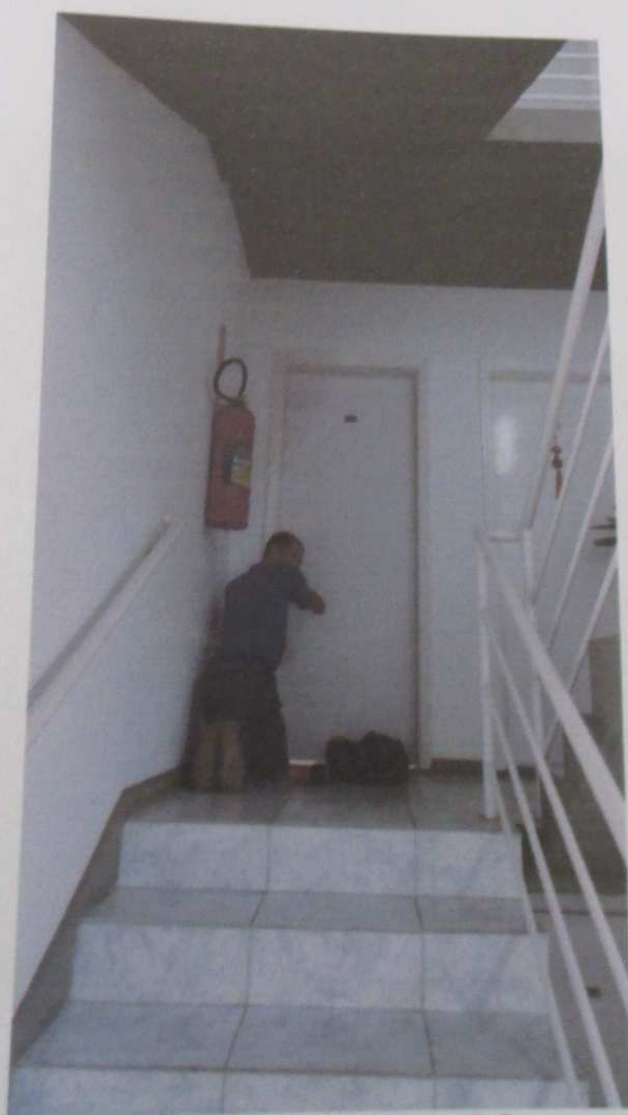
006 - DSCN0883.JPG Escada e entrada do apartamento 23. A unidade encontrava-se fechada e inabitada desde a conclusão das obras
