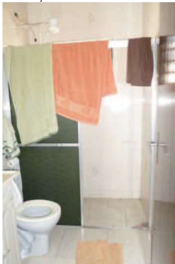
Foto 10 – Vista do banheiro com laje de forro, piso cerâmico de acabamento simples.
