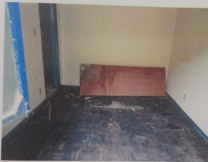
PISO DANIFICADO EM UM DOS CÔMODOS DA RESIDÊNCIA
