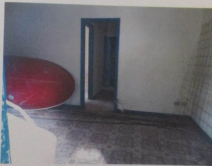
EDIFICAÇÃO EM ESTADO PRECÁRIO DE CONSERVAÇÃO
