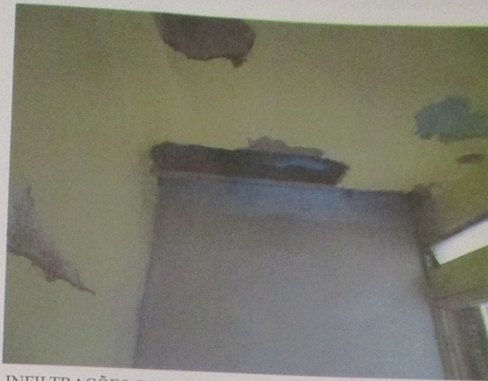
INFILTRAÇÕES COMPROMETENDO A LAJE DA RESIDÊNCIA
