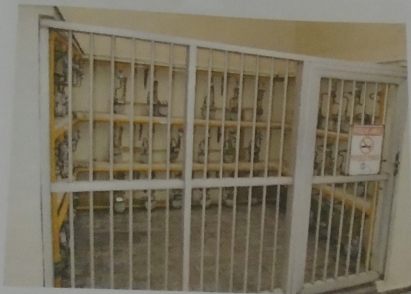
Foto nº 25 – Central de Medição de GLP – Pavimento Térreo
