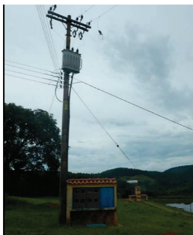
Foto 43: Ilustra entrada secundária da Rede de Energia Elétrica, que abastece apenas a alguns poucos chalés.
