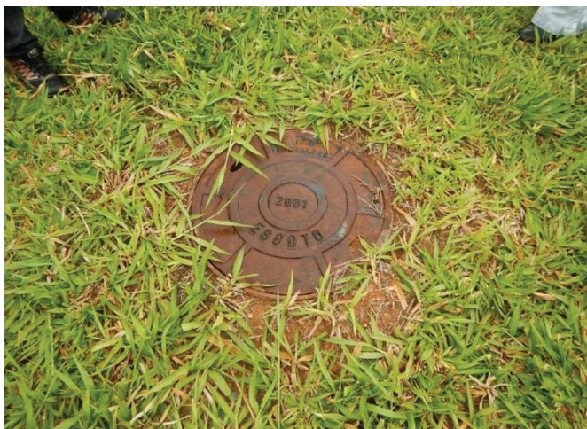
Foto 42: Ilustra que a Rede de Esgoto está implantada desde cerca de 2001.
