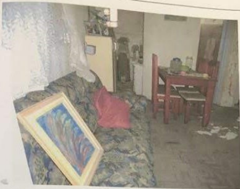
FOTO 03:- Vista da sala do imóvel. Vista da degradação do imóvel com manchas de infiltração nas paredes da cozinha e banheiro.
