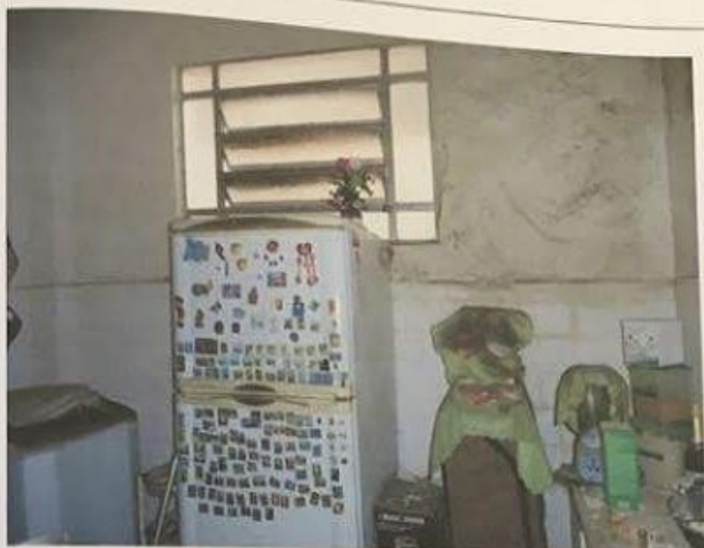
FOTO 05:- Vista da cozinha do imóvel com degradação do reboco da parede.
