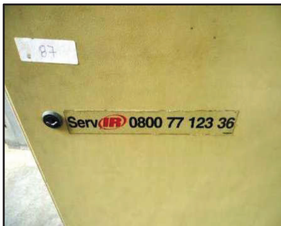
COMPRESSOR DE AR
