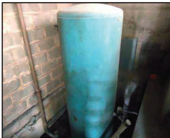
RESERVATÓRIO DE AR COMPRIMIDO
