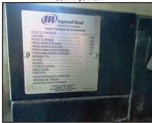
COMPRESSOR DE AR
