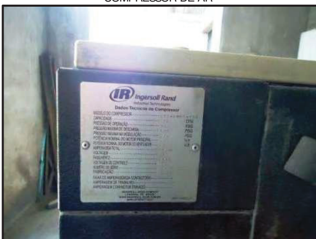
COMPRESSOR DE AR
