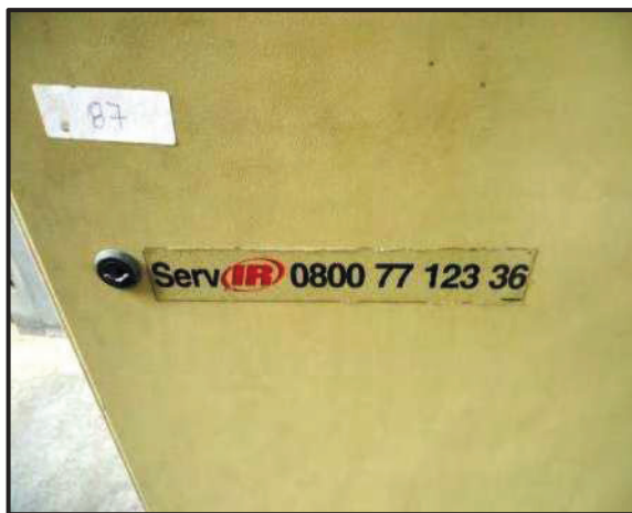
COMPRESSOR DE AR
