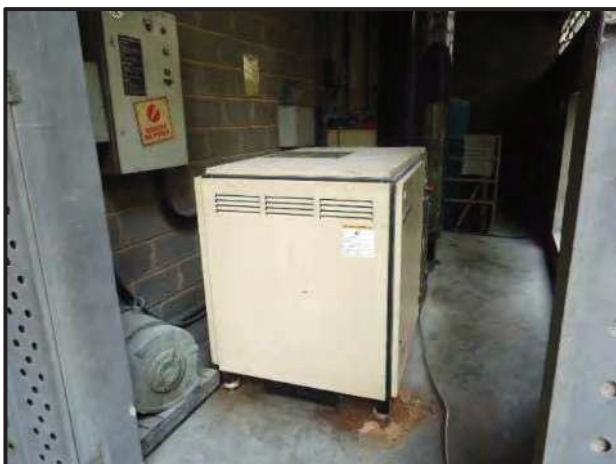
COMPRESSOR DE AR
