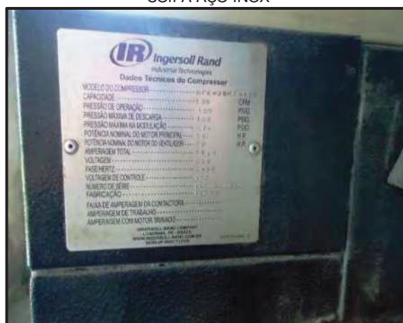
COMPRESSOR DE AR
